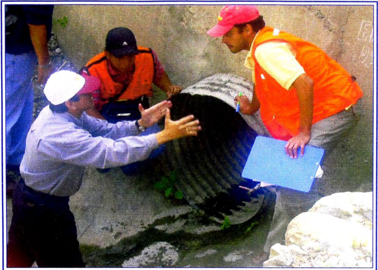
Foto N°1: Reconocimiento en campo del estado de las obras de drenaje, vemos que la salida de la alcantarilla, la tubería metálica corrugada, se encuentra descubierta, debería quedar protegido dentro del concreto del cabezal de salida
