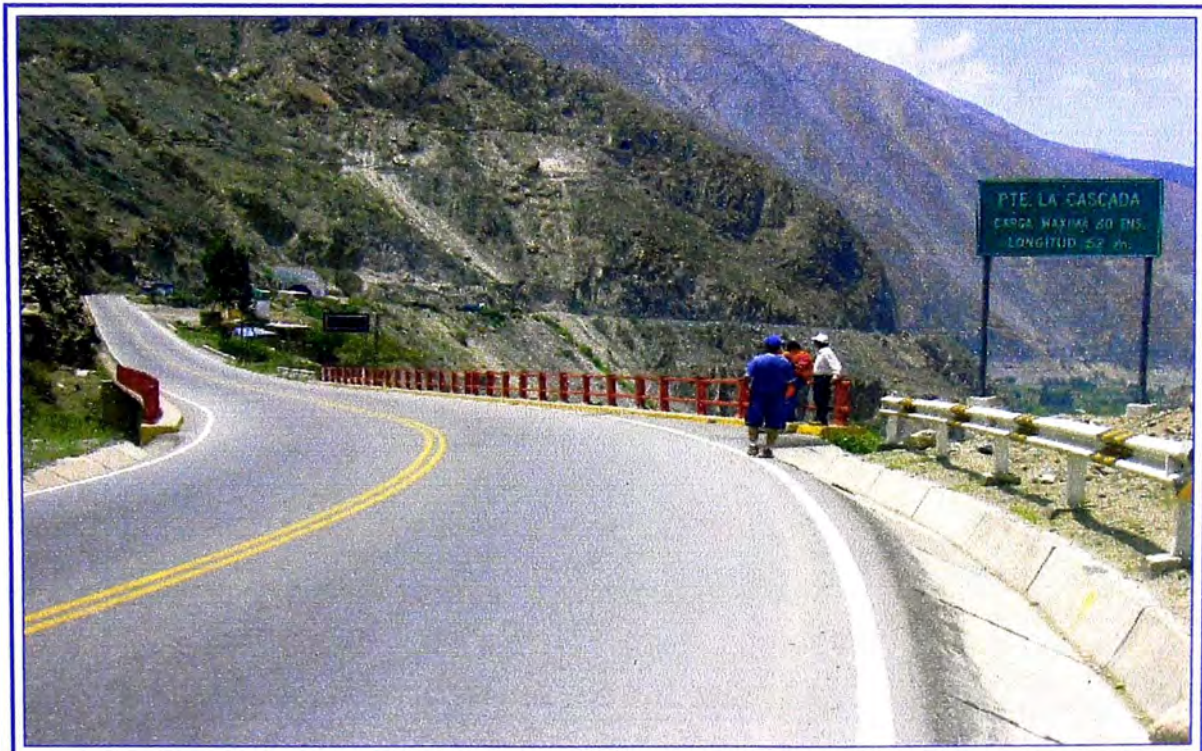
Foto N°10: Km 59+180, un buen mantenimiento rutinario ayudara a conservar el pavimento, como la limpieza constante de cunetas, limpieza de desprendimiento de materiales caídos del talud a la vía, sello superficial, etc.
