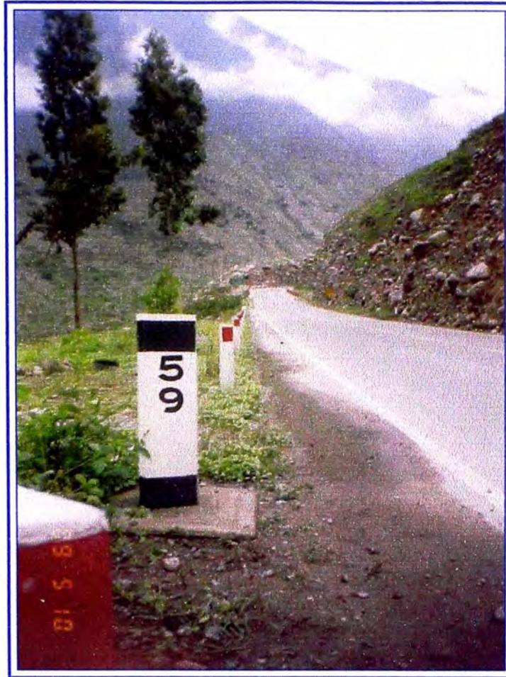
Foto N°9: Km. 59+00, el clima es un factor para considerarlo en el daño al asfalto ya que los cambios de temperatura envejecerá al asfalto perdiendo sus propiedades de ductilidad y elasticidad.
