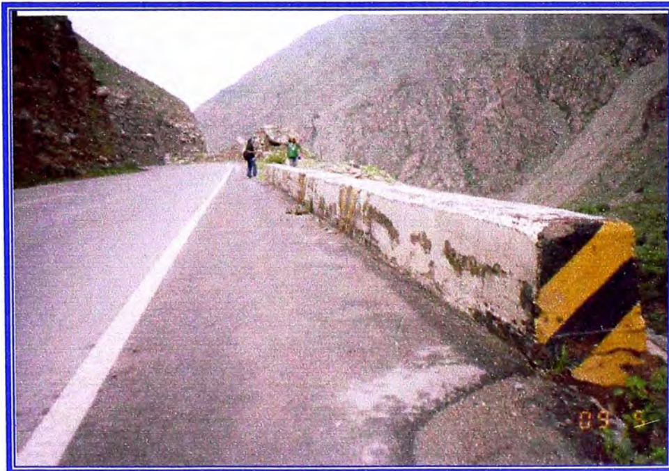
Foto N°14: Bordillo de muro de contención, muestra la deficiente señalización; su estado actual puede ser causa de accidentes. Urge el mantenimiento de la señalización, para brindar la seguridad en el tramo.
