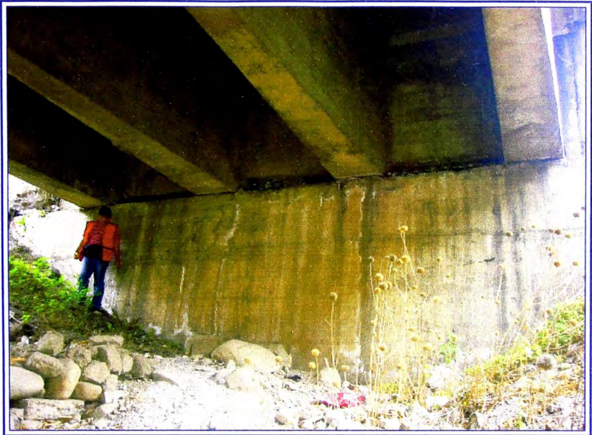
Foto N°3: Puente La Cascada; urge darle el mantenimiento, se observa el fisuramiento del estribo derecho del puente I, y los aparatos de apoyo se encuentra en mal estado
