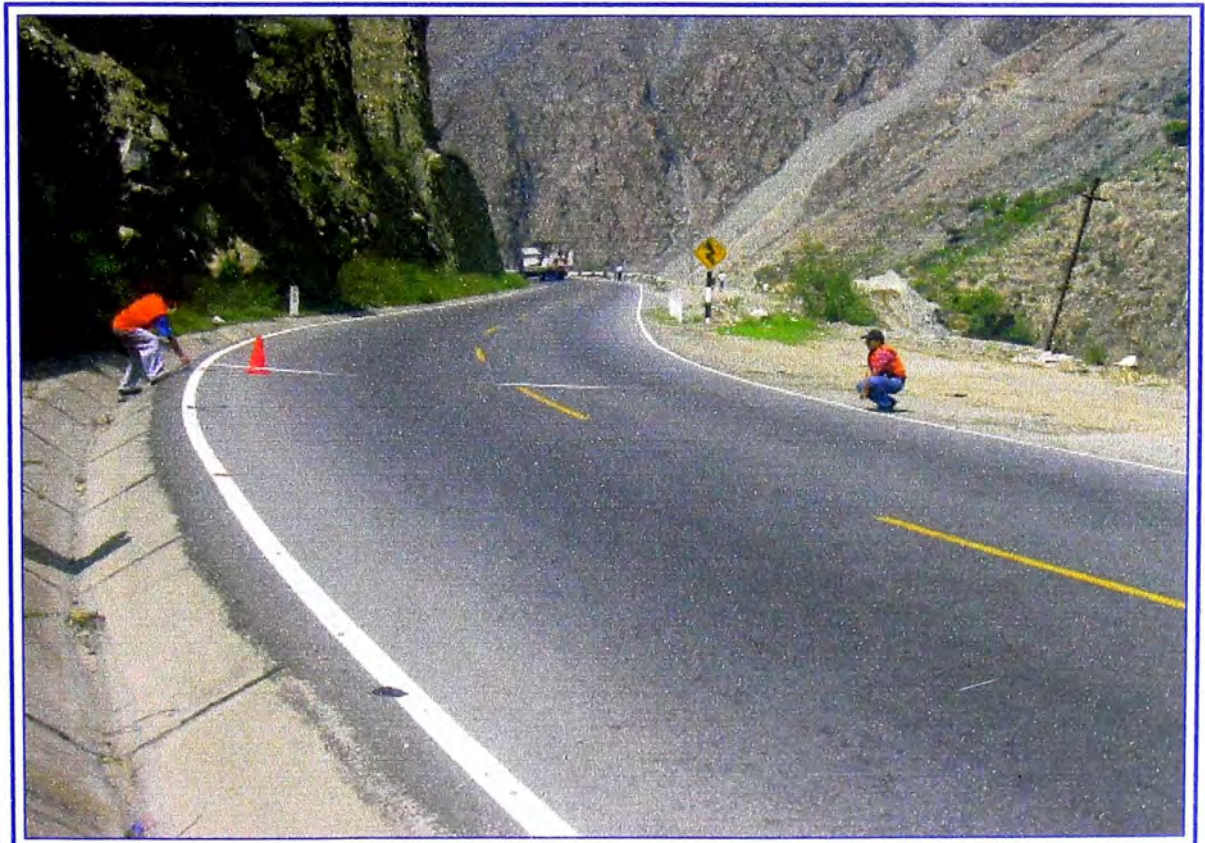
Foto N°2: Reconocimiento en campo, Trazo y diseño vial, comprobación del sobreebanco en las curvas, el peralte y las longitudes en tangente; esta ultima característica no cumplía, por lo que se propuso sobreebanco hacia el lado del río con sus respectivos muros de contención.
