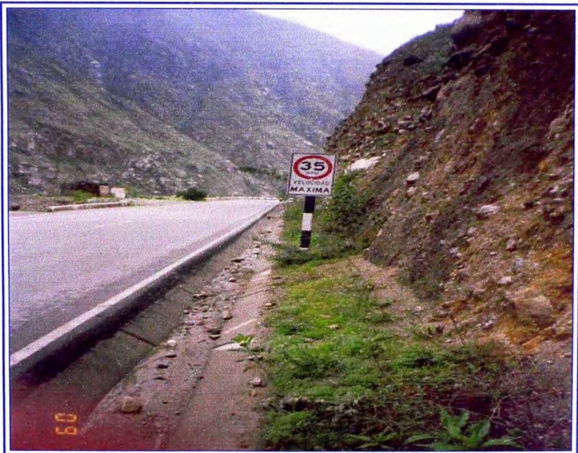
Foto N°8: Km. 59+690, se observa empozamiento a causa de falta de limpieza de la cuneta, esto saturara las capas inferiores del pavimento degradando su resistencia, siendo sensible de fallar estructuralmente producto del tráfico pesado, según esta condición se prevé para tomar en cuenta el coeficiente de drenaje para la estructuración del pavimento (mi)
