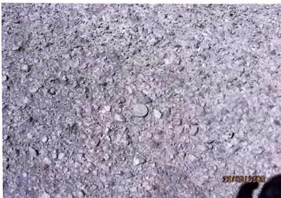
TOMA 1 PERDIDA DE FINOS
