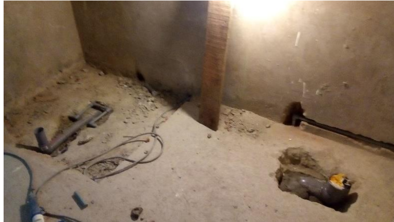
Figura N°5.21 Diversos cambios y/o correcciones sanitarias por cambio de diseño en baños Fuente: Elaboración propia
