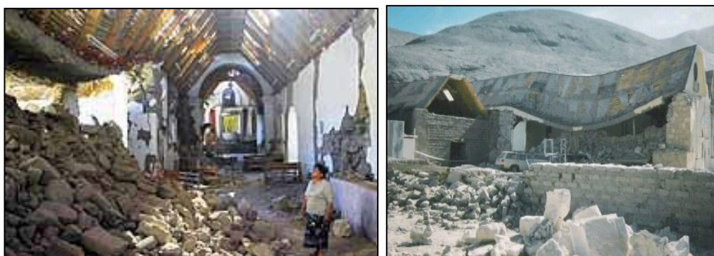
Figura 4.10 Desplome de muros y techo de la Iglesia San Lorenzo - Tarapacá
