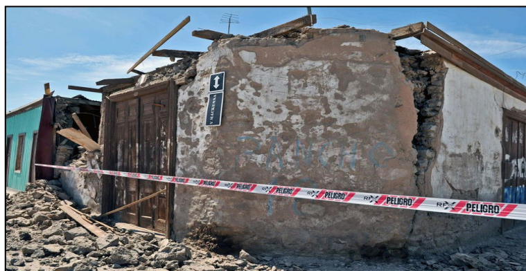
Figura 4.9 Daños registrados en Tarapacá
