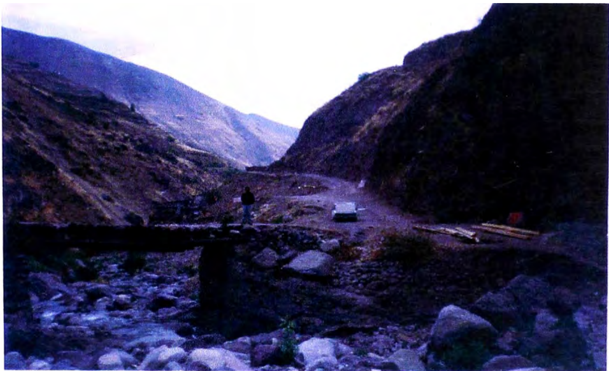
Verificación de la obra de Rehabilitación del Camino Vecinal por el Supervisor del Proyecto
