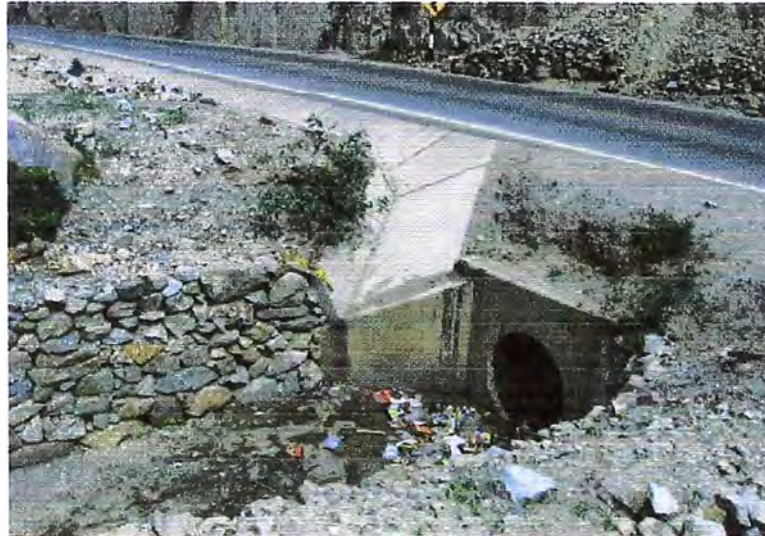
Figura N° 1 Se muestra la alcantarilla que requiere mantenimiento
