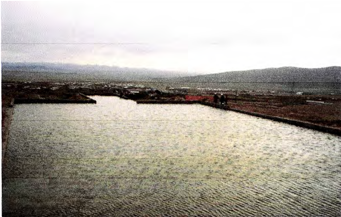
Foto N° 1: Estanque de Regulación de Concreto Armado, donde se almacena el agua proveniente de la Laguna Yanacocha
