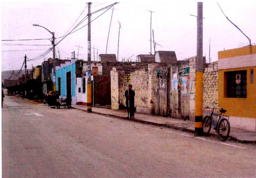
Foto Nro 10: Se observa el trabajo del levantamiento topográfico de los bordes de las pistas. La vista corresponde al trabajo realizado en la Plaza de Armas.
