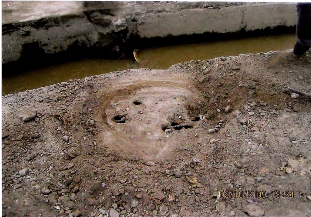
Foto Nro 9: En la foto se observa el estado actual en que se encuentra El sistema de alcantarillado en la localidad. La vista corresponde a una Tapa de buzón ubicada en la calle San Martin.
