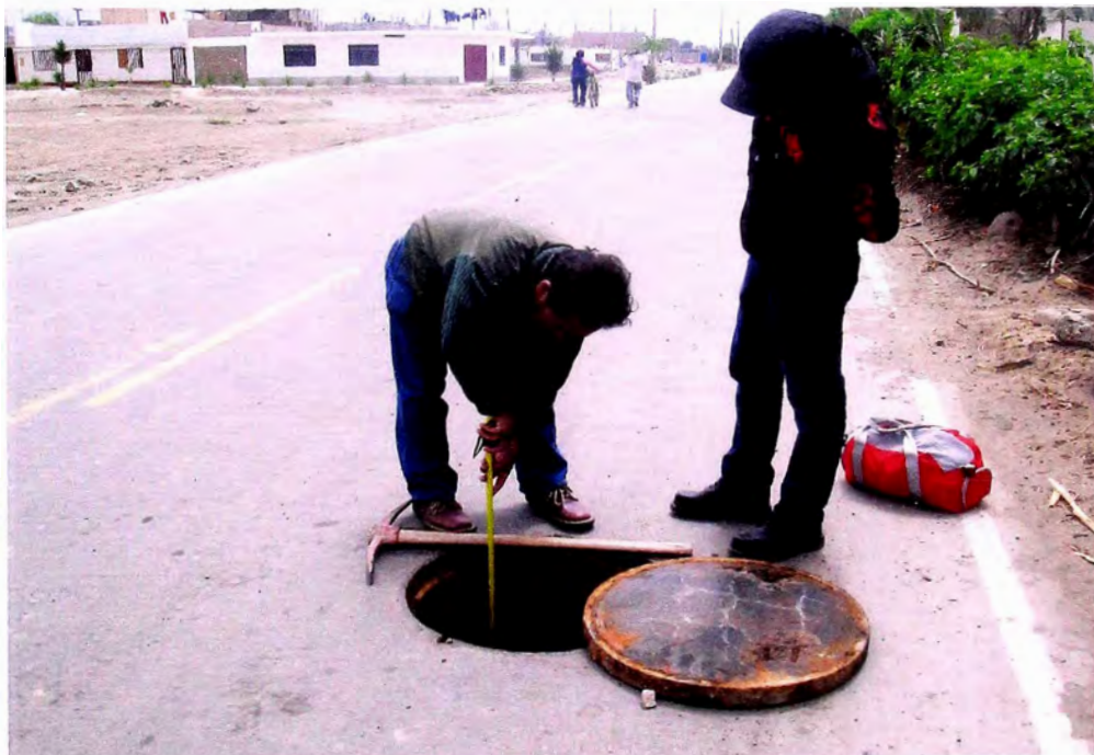
Foto Nro 4: En la foto vemos como se destapo las tapas de los buzones existente para verifcas su estado actual. La vista corresponde a un buzón en la carretera Santa Barbará.
