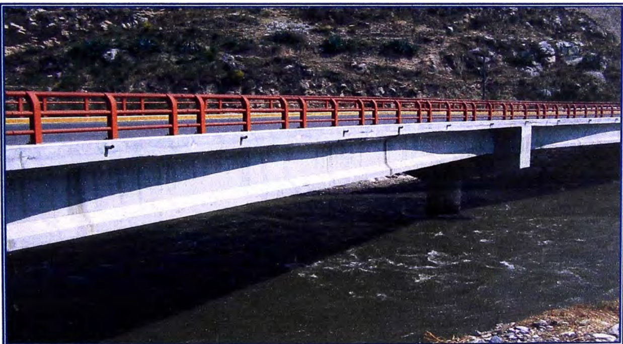
FOTO N° 14: VISTA DEL PUENTE STUART. Este puente es la entrada a la ciudad de Jauja, cabe resaltar que tiene una longitud de 83 m. y una carga máxima de 48 toneladas.
