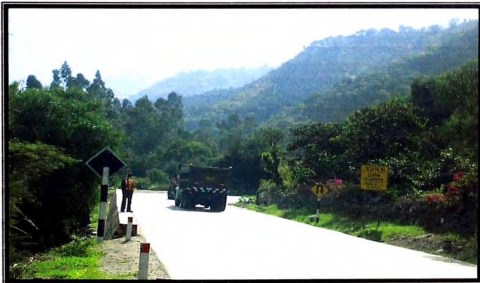
FOTO N° 06: Vista hacia adelante Km. 64+900. Se observa vehículos pesados C2 que invaden el carril contrario al ingresar a la primera curva de volteo conformada por una curva compuesta N° 59 y 60, cuyos radios son menores a los radios mínimos. Se aprecia señales preventivas.
