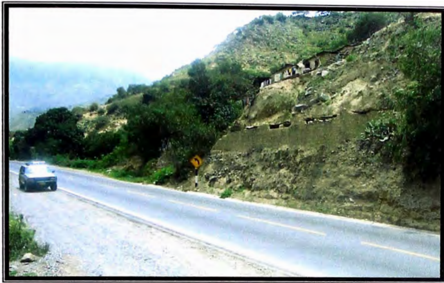
FOTO N° 13: Vista hacia adelante Km. 65+750. Se puede apreciar viviendas en el hombro del talud de corte, en zona de riesgo y dentro del faja de dominio de la vía.
