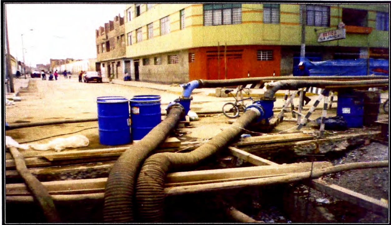
Foto 31 (arriba): Dos electrobombas adicionales de \Phi 10'' en pleno funcionamiento.
