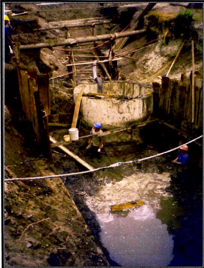
Foto 19 (izq): Buzón tipo caisson para bombeo de la cámara de reunión final C.R.2. Finalmente, la tubería sólo lo cruzó y quedó todo enterrado
