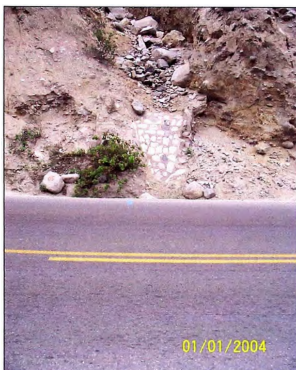
Foto N° 4.- Material presente en el tramo 2, flujo de escombros coluvio-aluvional y tiene una potencia máxima de 8 m.
