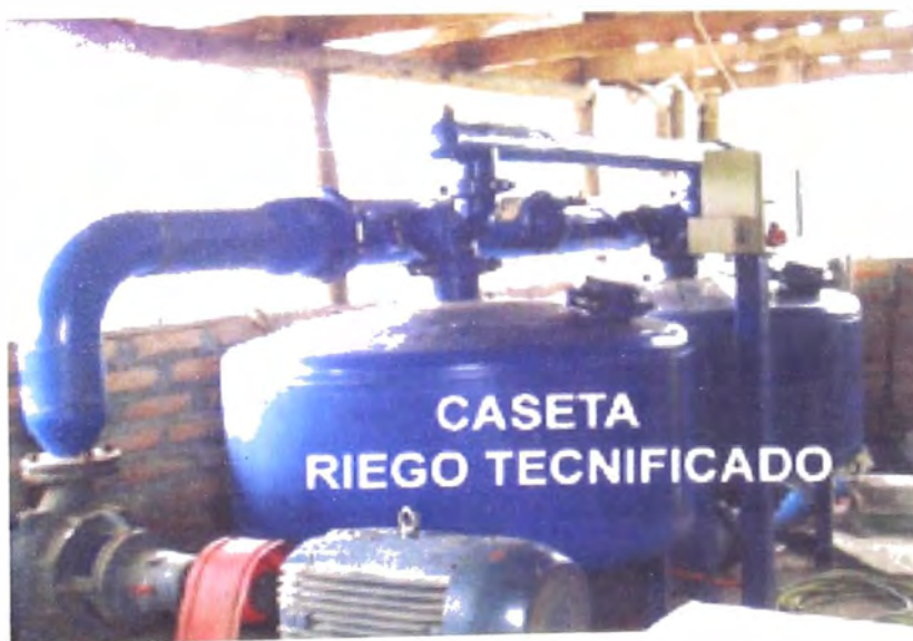
Figura A-1: Cabezal de Riego: bomba eléctrica, filtros de arena y filtro de mallas.
