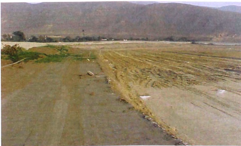
FOTO N° 111.- Eliminación de obstrucciones, en la vista se observa rezagos de la eliminación de la tala de árboles y arbustos, donde se ubica el reservorio de compensación.
