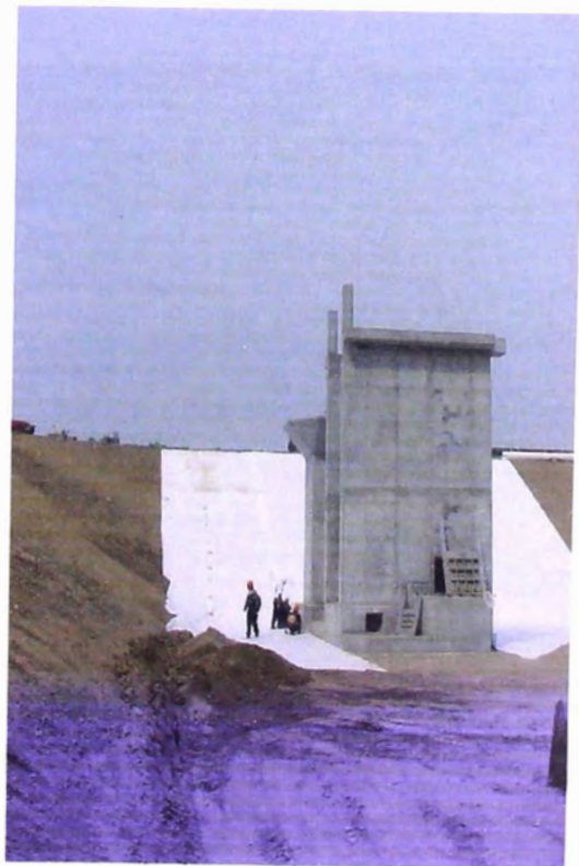
FOTO N° 166.- Estructura de salida, se observa las compuertas planas de accionamiento manual por instalar.
