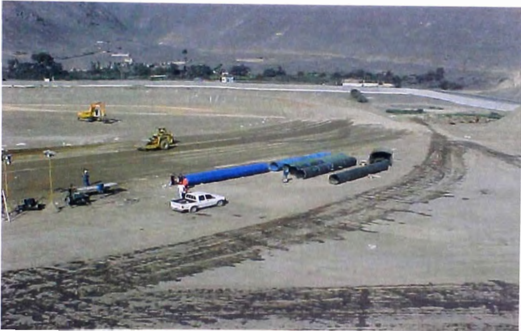
FOTO N° 141.- Similar a la foto anterior, se observa tuberías de la estructura de salida del otro estanque del reservorio de compensación.
