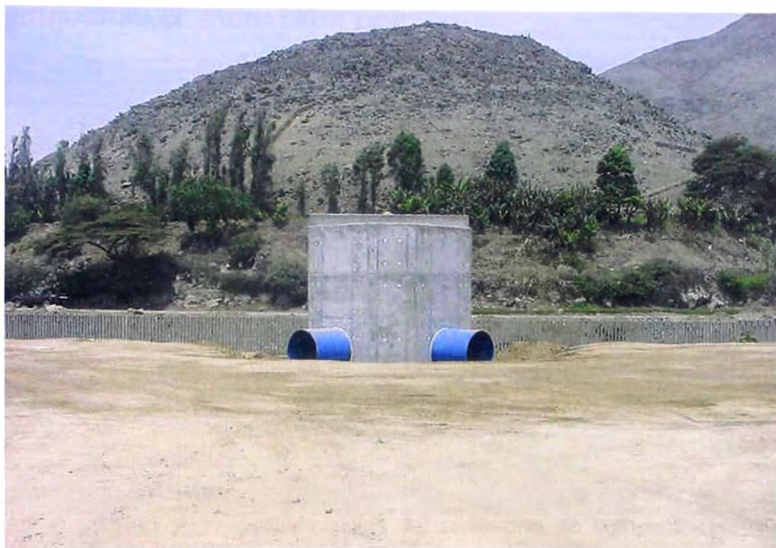
FOTO N° 148.- Estructura de entrada del reservorio de compensación interior , se observa la cámara de repartición de concreto armado desde una vista interior y/o anterior del estanque, las tuberías de distribución metálica de 1,200 mm de diámetro por empalmar, para c/u de los estanques del reservorio de compensación.
