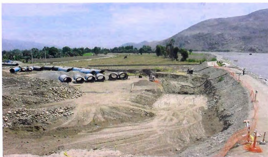
FOTO 74.- Línea de conducción , entre bocatoma y planta de tratamiento, donde se observa las tuberías de concreto armado pretensado – CAP, de 1,400 mm de diámetro, ubicado a la salida de las obras de captación.
