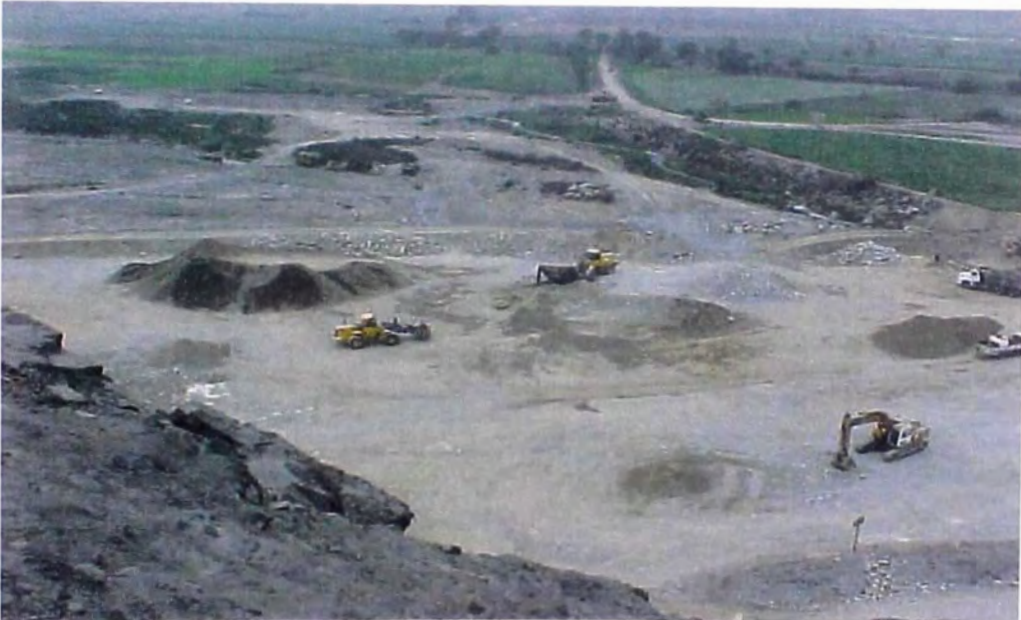
FOTO N° 117.- Cantera material aluvial , de donde se obtiene el material gravoso fino para la conformación del terraplén del reservorio de compensación, donde se observa a dos cargadores frontales zarandeando dicho material.
