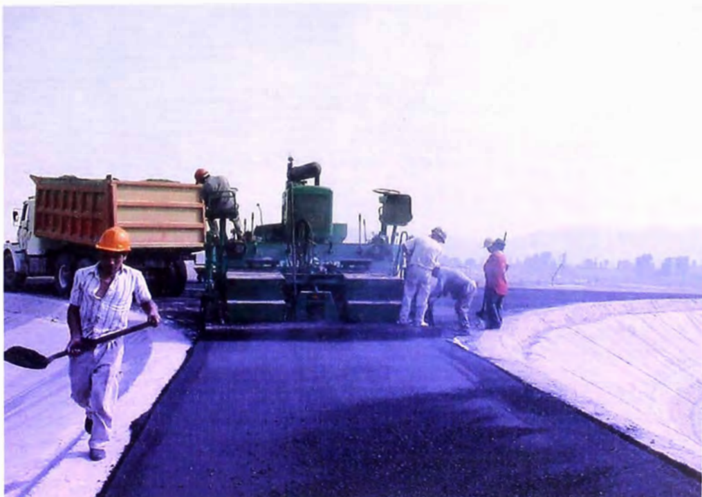
FOTO N° 196.- Asfaltado , se observa culminando los trabajos de colocación de la carpeta asfáltica en la plataforma de la corona del reservorio de compensación.
