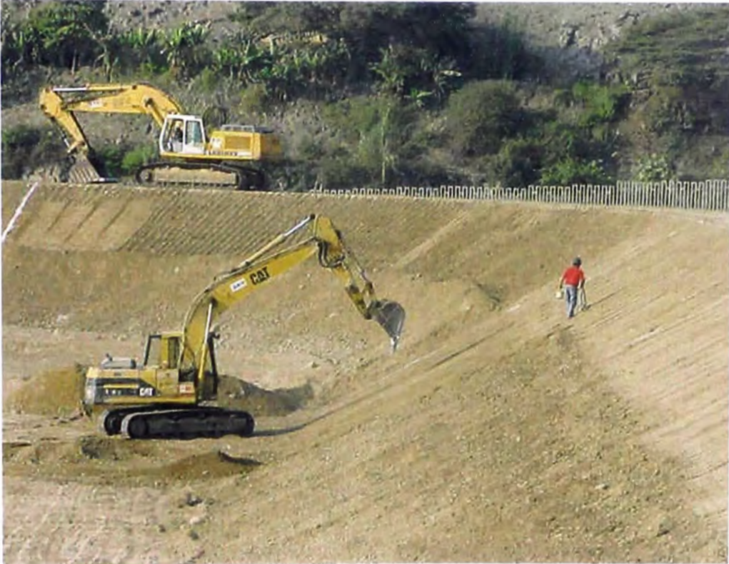
FOTO N° 135.- En la vista se observa a dos retroexcavadoras sobre oruga, peinando el talud interior, de la parte inferior y superior del relleno respectivamente, del reservorio de compensación.
