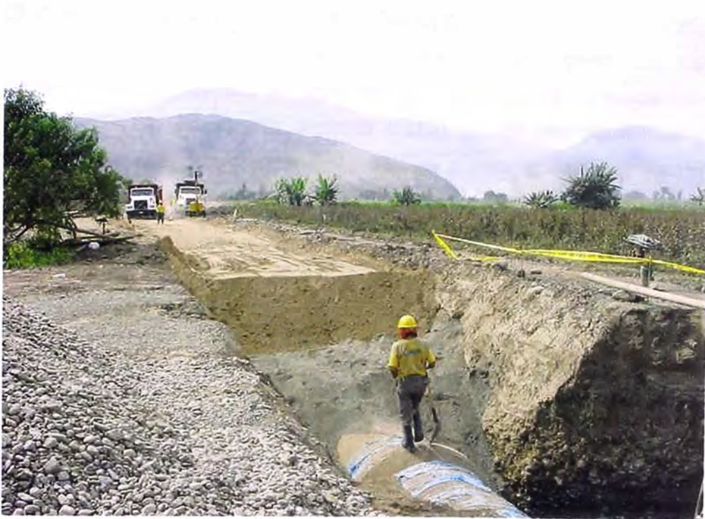
FOTO 92.- Tubería de conducción; de la línea desde la obra de captación a la Planta de Tratamiento, se observa
