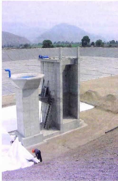
FOTO 171.- Construcción del reservorio de compensación , donde se observa panorámicamente la estructura de salida de uno de los estanques del reservorio de compensación y uno de los niveles donde se instalará una compuerta plana de accionamiento manual.
