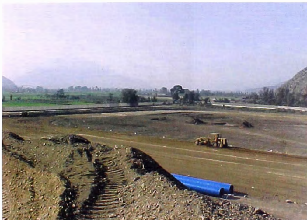
FOTO N° 130.- Se observa a una motoniveladora, en el extendido del material afirmado mejorado, para la nivelación del dique perimetral del reservorio de compensación.
