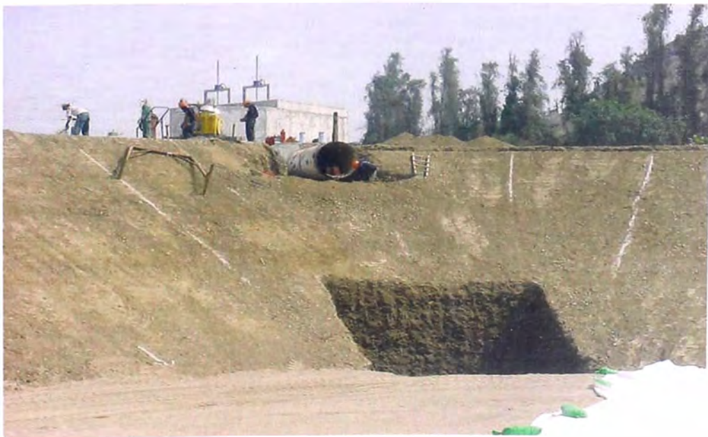
FOTO N° 122.- Excavación local, se observa la excavación para el canal de la tubería de conducción en la estructura de entrada al reservorio de compensación.
