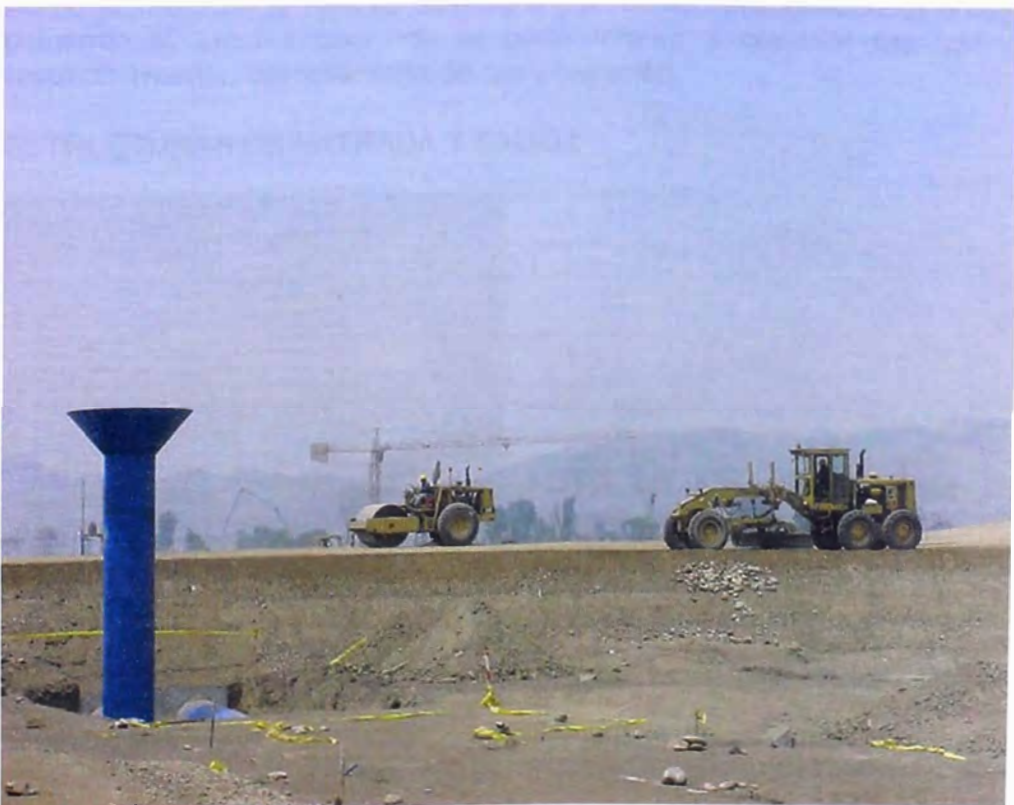
FOTO N° 134.- Se observa una motoniveladora y un rodillo liso autopropulsado en trabajos de nivelación y compactación respectivamente, para el terraplén del dique del reservorio de compensación.
