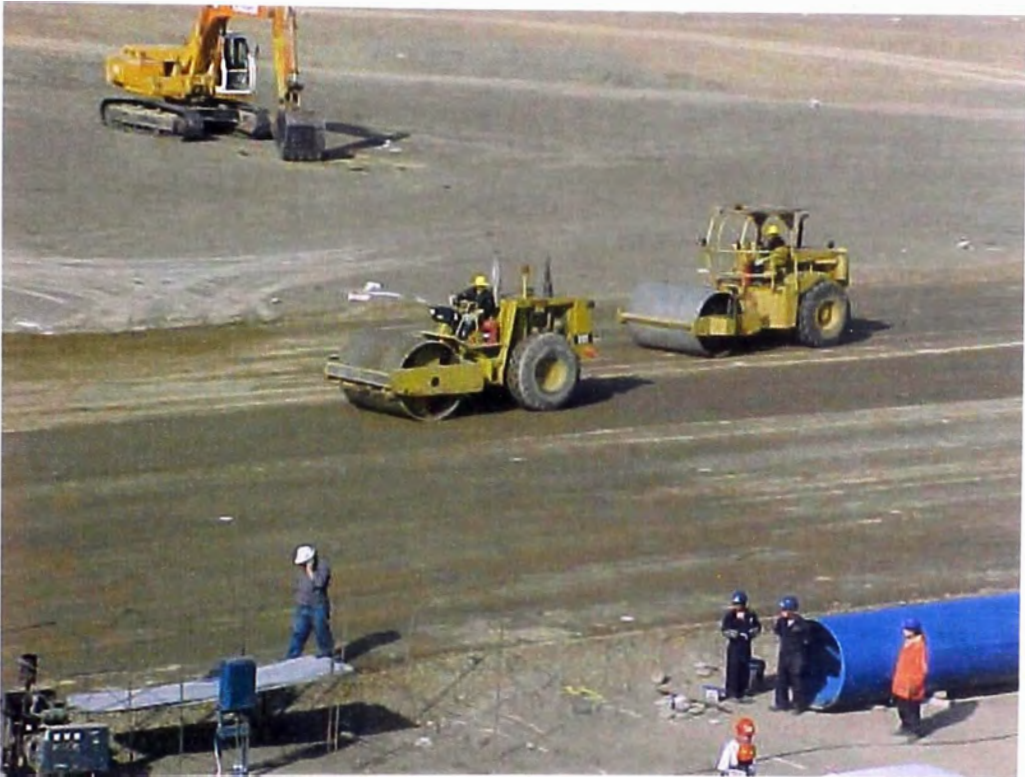
FOTO N° 133.- Se observa a dos rodillos lisos autopropulsados, compactando la plataforma del dique perimetral del reservorio de compensación.
