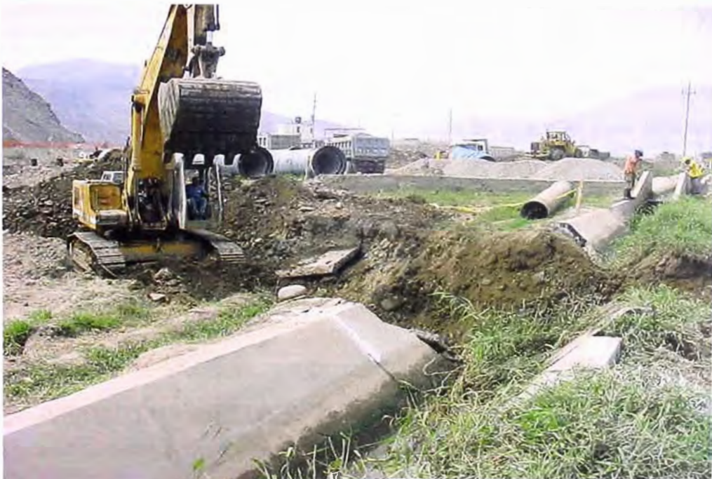
FOTO 87.- Zanja con encuentro de canal de concreto; se aprecia la rotura del canal por el tendido de la tubería de la línea de conducción, tubo que reponerlo posteriormente por el Contratista.
