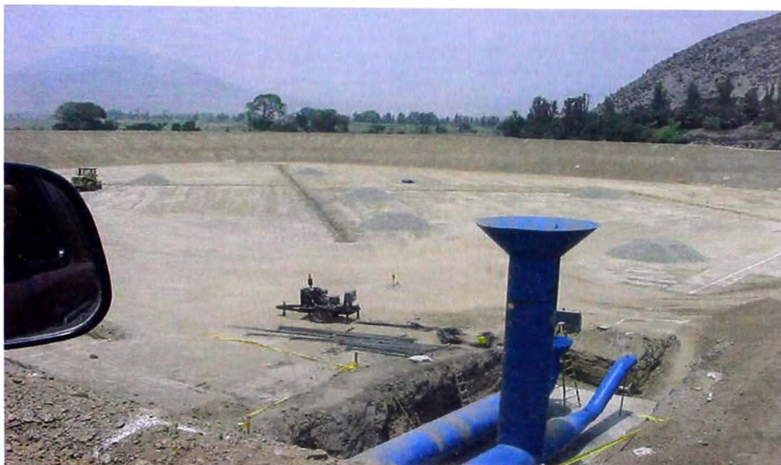
FOTO N° 152.- Estructura de salida del reservorio de compensación, se observa la cimentación de concreto simple ejecutada y las tuberías metálicas de rebose con su vertedero tipo "moming-glory" y la de drenaje, de uno de los estanques del reservorio de compensación.
