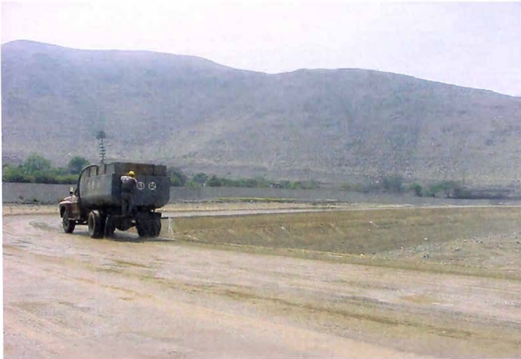
FOTO N° 131.- En la vista se aprecia, a un camión cisterna en pleno riego de la plataforma del dique del reservorio de compensación, para su compactación correspondiente.
