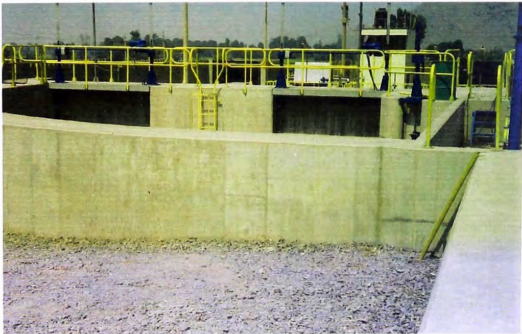
FOTO 25.- Compuertas plana de accionamiento manual , instalados en los dos tanques del desarenador secundario de la obra de captación.
