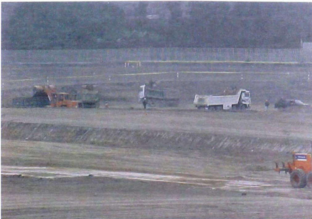
FOTO N° 113.- Movilización de equipo mecánico , tales como: cuatro camiones volquetes, un cargador frontal, entre otros, en la zona de excavación para la cimentación del dique del reservorio, y extracción, carguio y transporte como material propio.
