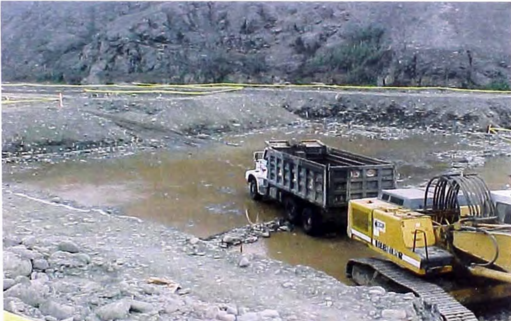
FOTO 47.- Construcción del barraje , donde se observa la excavación masiva ya ejecutado en el cauce del río en un tramo de 25 ml de longitud, para la construcción de la cimentación y estructura del barraje.
