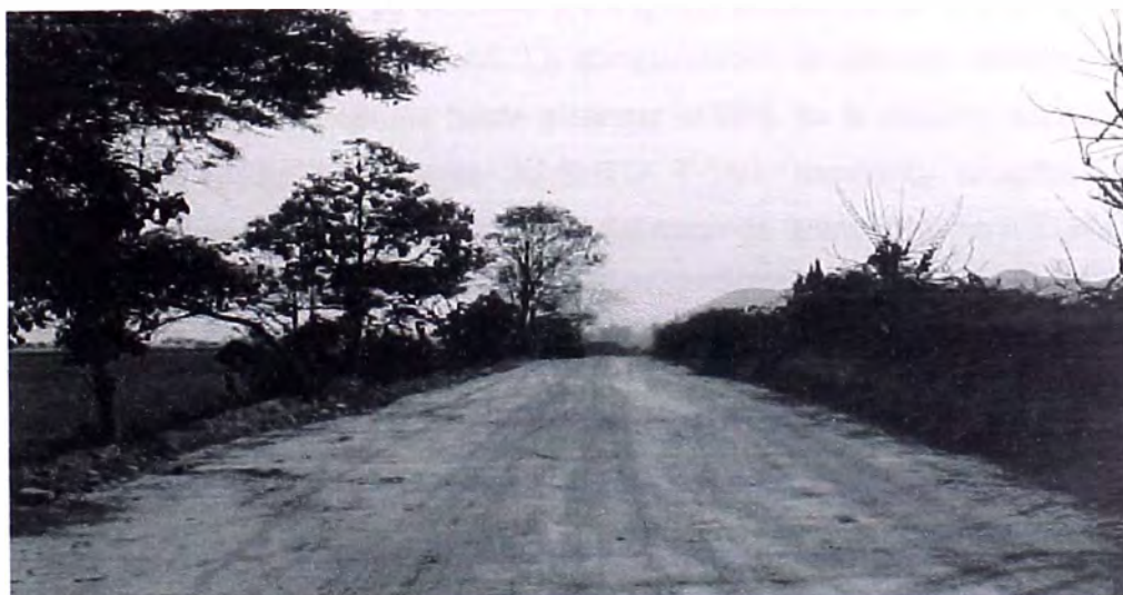
FOTO N° 40.- Trocha carrozable, ejecutada para el desplazamiento de los móviles y equipo mecánico para las diferentes obras del proyecto, entre la bocatoma y la planta de tratamiento.
