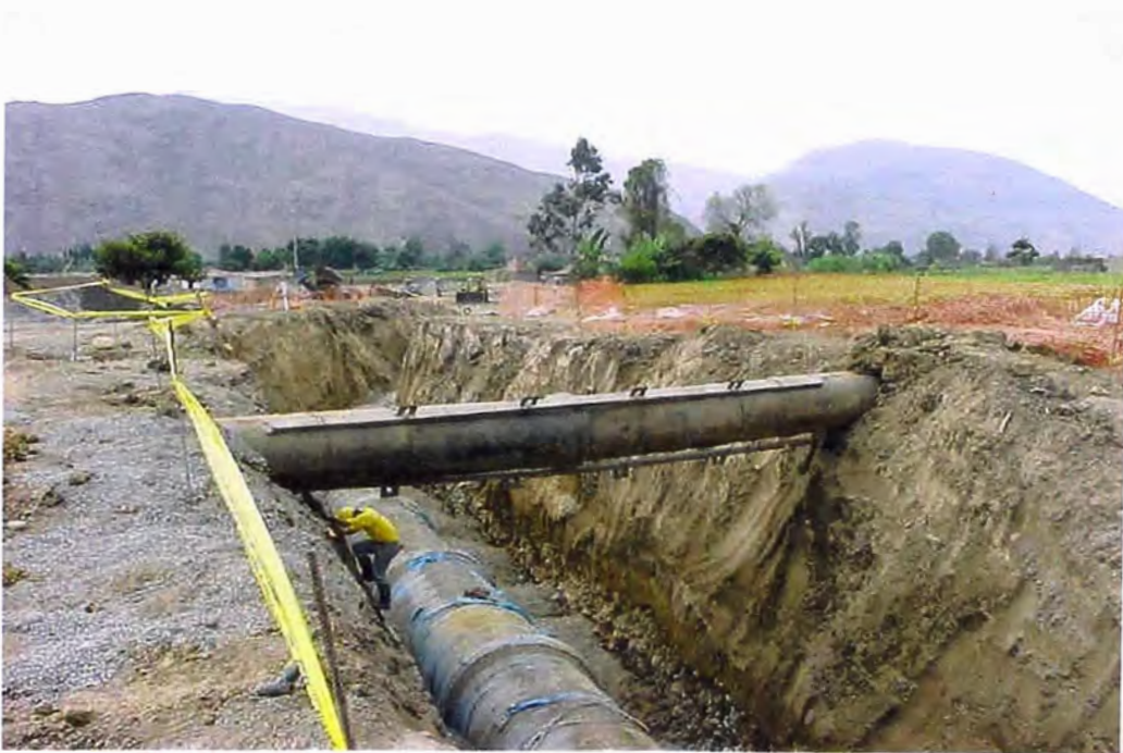
FOTO 86.- Cruce de la línea de conducción con canal de tubería para riego; obstáculo que dificultó en parte el proceso del tendido de la tuberías.
