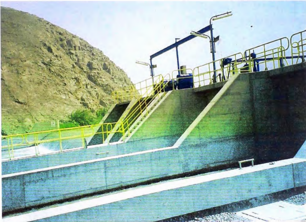
FOTO 26.- Compuerta plana motorizada , instalado en la obra de toma de la bocatoma.
