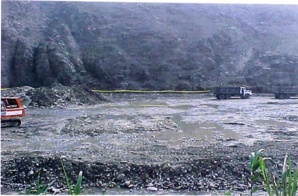
FOTO 54.- Construcción del barrage, donde se observa el transporte del material de préstamo aluvial: afirmado, seleccionado.
