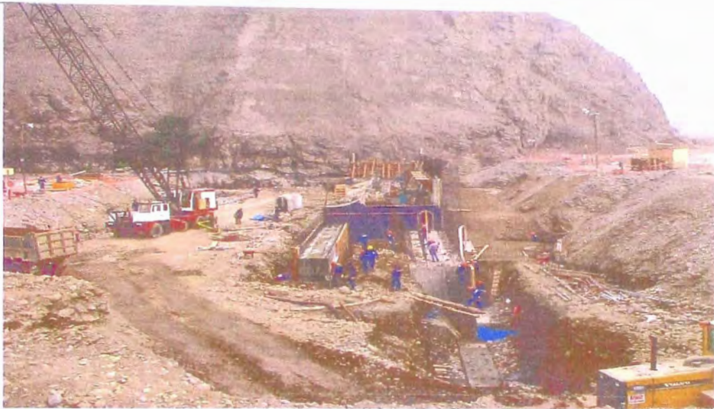
FOTO 57.- Construcción del barraje , donde se observa como se ha realizado el vaciado de concreto simple por etapas de la cimentación de tipo directo.
