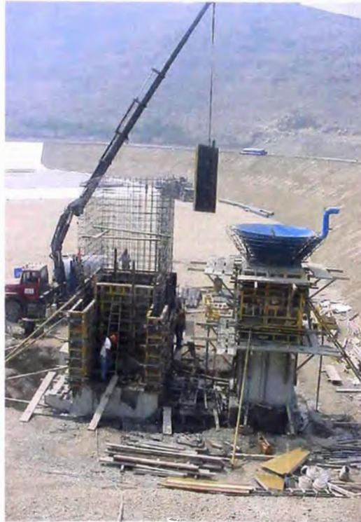
FOTO N° 156.- Encofrados y armadura; se observa de las cámaras de estructuras de salida en pleno proceso para el vaciado de concreto de sus muros.
