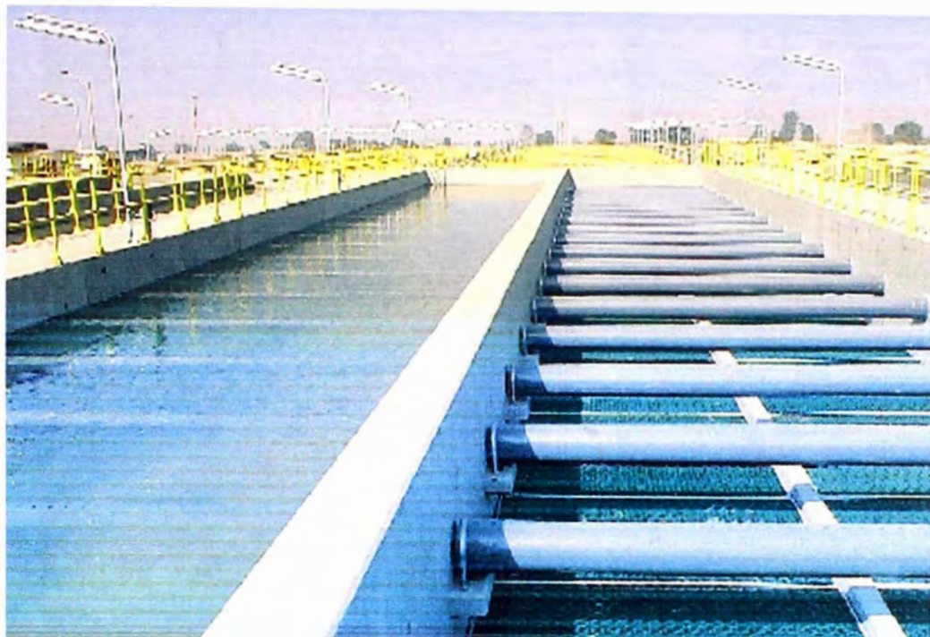
FOTO 07.- Sedimentadores laminares de placas, donde cada sedimentador cuenta con dos secciones paralelas (nave) de placas inclinadas, separadas por un canal a dos niveles: el inferior que alimenta los sedimentadores y el superior donde se vierte el agua clorificada.
