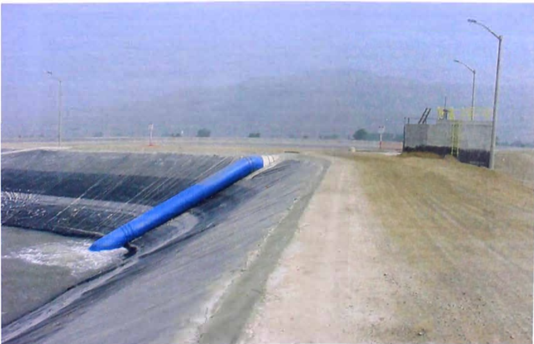
FOTO N° 151.- Estructura de entrada final del reservorio de compensación, se observa la parte final de la tubería de distribución para uno de los estanques del reservorio de compensación, en pleno funcionamiento con el flujo de agua de la bocatoma al estanque a prueba, concluido el canal y el muro de concreto.
