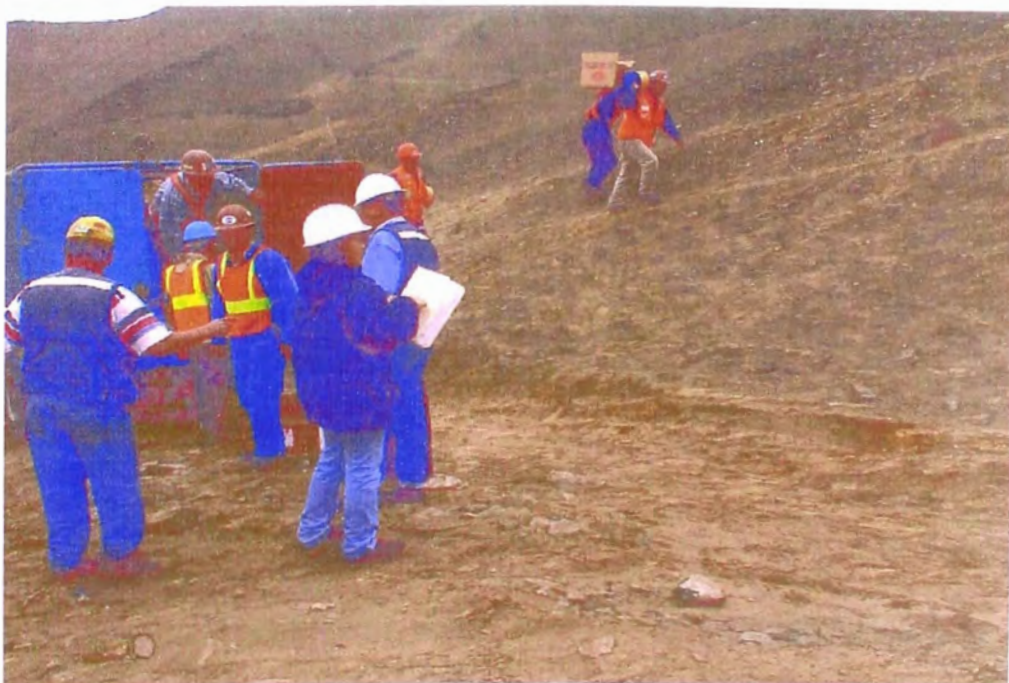
FOTO 124.- Construcción del Reservorio de Compensación, donde se observa el traslado de los elementos necesarios de explosivos en la inspección previa para determinar su colocación, para trabajos de corte en material semi rocoso.
