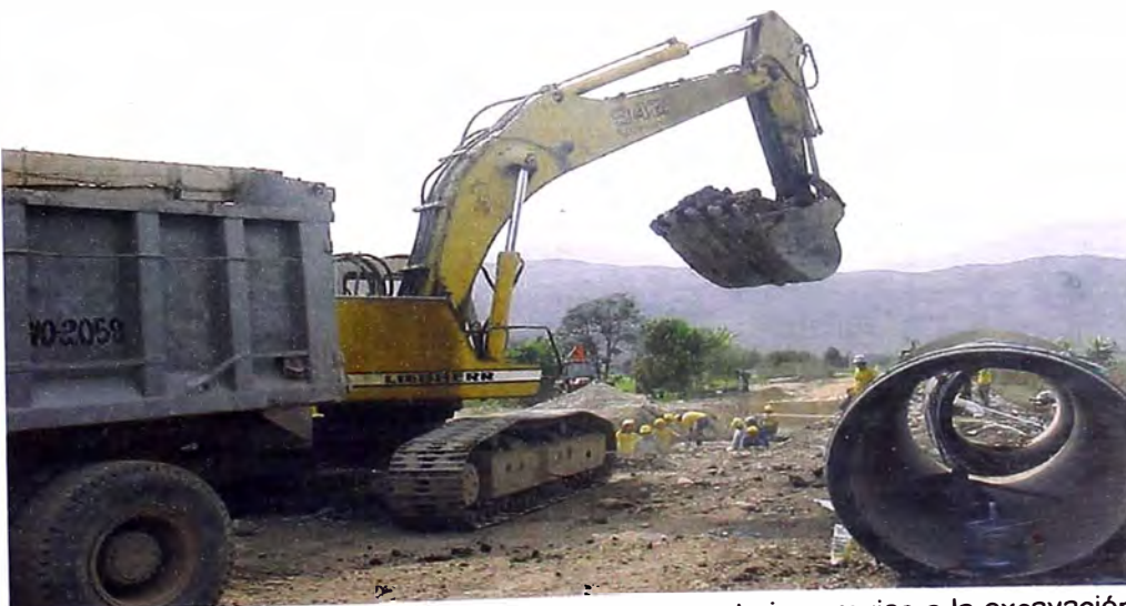
FOTO 78.- Línea de conducción; se observa los trabajos previos a la excavación en el tendido de las tuberías de la línea, desde la Obra de Captación a la Planta de Tratamiento.
