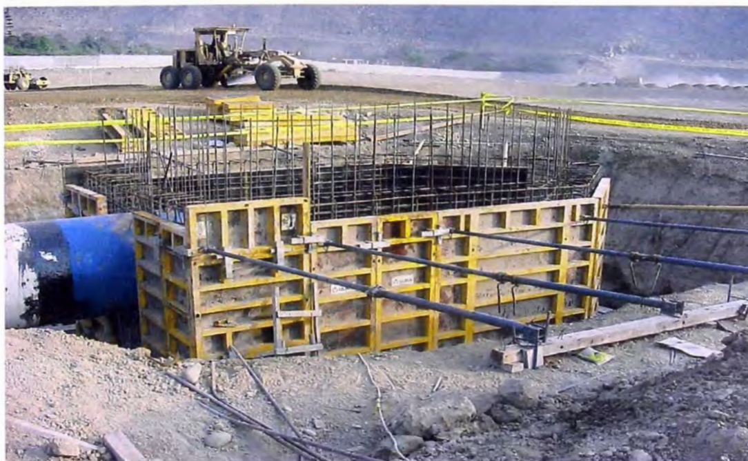
FOTO N° 147.- Armadura , de la estructura de entrada del reservorio de compensación, se observa la tubería de recolección de CAP de 1,400 mm de diámetro llegando a la cámara del reservorio de compensación, asimismo la armadura colocada y el encofrado de la cámara listo para el vaciado de concreto.
