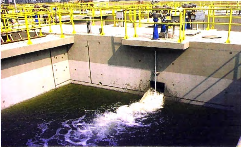
FOTO 08.- Filtros de gravedad, en el marco de la utilización de la energía del agua, para el proceso de retrolavado se ha diseñado un sistema de filtración que no requiere equipo mecánico.
