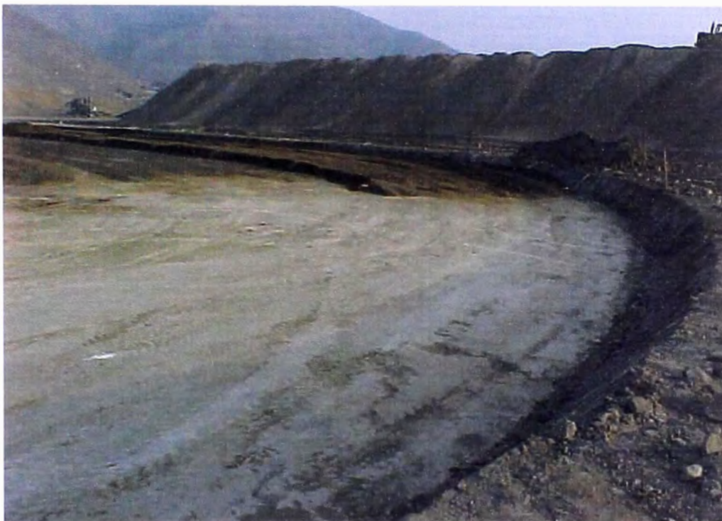
FOTO N° 129.- Se observa la plataforma preparada en un tramo y el otro en riego, del dique perimetral del reservorio de compensación.
