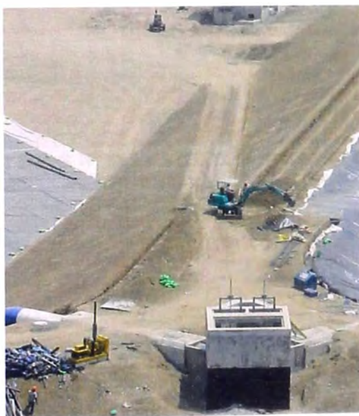
FOTO N° 158.- Estructura de entrada del reservorio de compensación, se observa las compuertas y las tuberías de bifurcación para c/u de los estanques.
