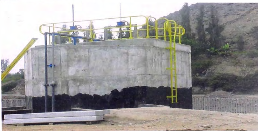
FOTO N° 159.- Compuertas planas de accionamiento manual, se observa la estructura de entrada y la distribución de las dos tuberías de 1,200 mm de diámetro a los estanques, asimismo, las dos compuertas planas de accionamiento manual, del reservorio de compensación.
