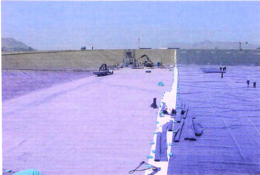
FOTO N° 180.- Geotextil, se observa la colocación parcialmente la primera capa de geotextil en color claro, seguida de la geomembrana en color oscuro, faltando colocar la siguiente capa de geotextil, para completar la impermeabilización del reservorio de compensación.
