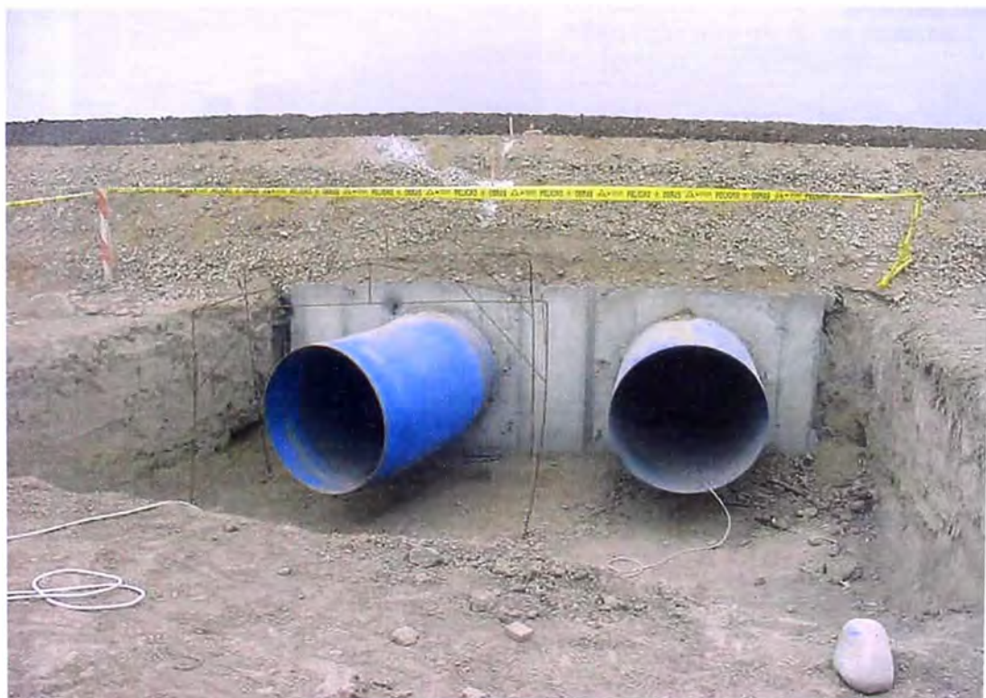
FOTO N° 155.- Estructura de salida del reservorio de compensación, se observa las tuberías de metal de 1,200 mm de diámetro llegando a la cámara exterior de uno de los estanques, con su muro de sostenimiento.
