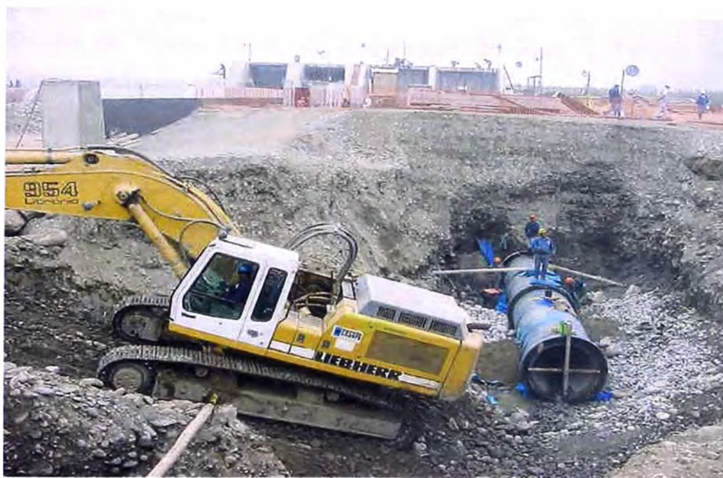
FOTO 56.- Instalación de la tubería , donde se observa la excavación de material suelto con una retroexcavadora, para la instalación de la tubería de concreto armado pretensado - CAP, al inicio de la bocatoma hacia la planta potabilizadora.
