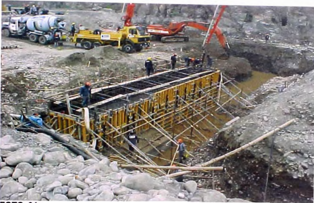
FOTO 64.- Construcción del barraje , donde se observa el encofrado de los muros de las pantallas del barraje, realizado por etapas.
