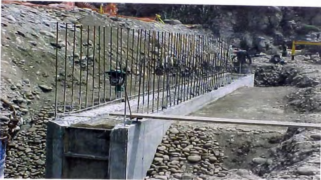
FOTO 51.- Construcción del barraje , donde se observa el relleno con material de préstamo y su compactación ejecutada del tramo aguas arriba de la pantalla.
