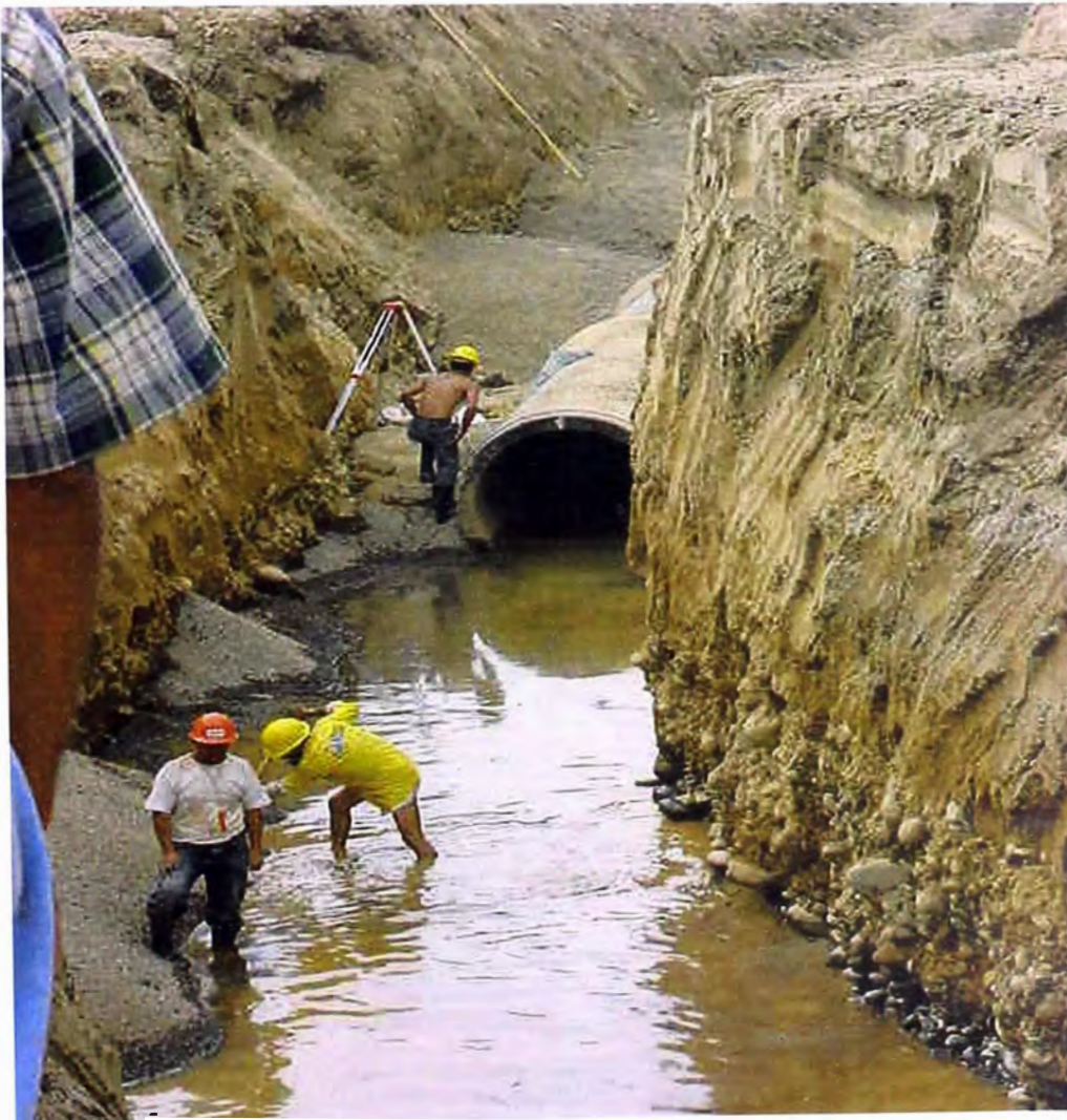
FOTO 95.- Tubería de conducción; se observa colocando la cama para la instalación de las tuberías con la zanja inundada por problemas de filtración.
