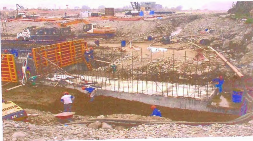
FOTOS 52 y 53.- Construcción del barraje , donde se observa el cextendido del material de préstamo seleccionado, y mezclado, aguas arriba de la pantalla del barraje, para su posterior compactación. Asimismo en la foto superior personal apisonando con vibrador portátil.
