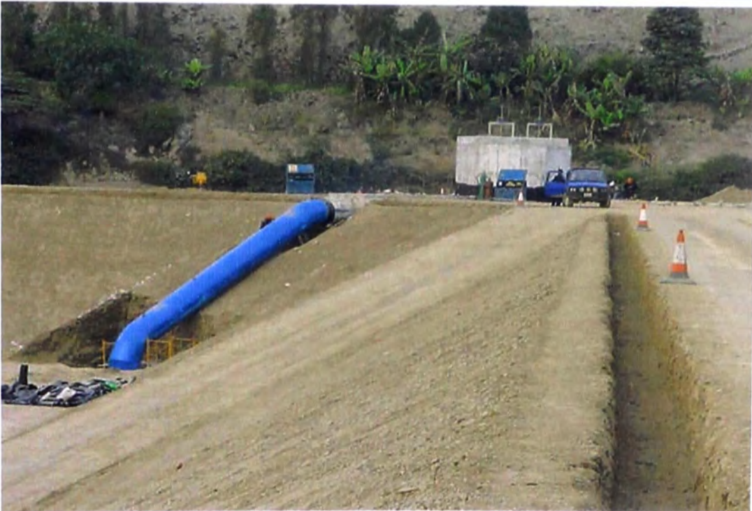
FOTO N° 150.- Estructura de entrada del reservorio de compensación, se observa la parte final de la tubería de distribución metálica de 1,200 mm de diámetro para uno de los estanques del reservorio de compensación, en proceso de construcción el canal de concreto armado y el muro de sostenimiento de la tubería.
