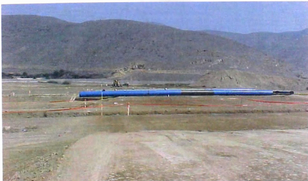
FOTO N° 140.- Se observa tuberías de una de las estructura de salida del estanque del reservorio hacia la parte externa del dique.
