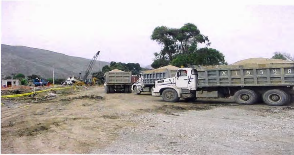
FOTO 90.- Transporte en volquetes del material de préstamo seleccionado para la cama del tendido de la tubería de la Línea de Conducción; en el tramo de la Obra de Captación a la Planta de Tratamiento.
