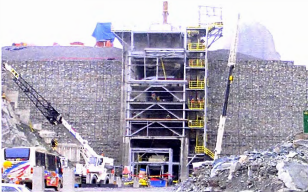
Foto N° 3 Muro Terramesh Chancadora Primaria - Alto Chicama (h máx : 23 m). Minera Barrick Misquichilca. La Libertad. 2004
