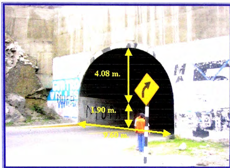
FIG N°17 Evaluación estructural de túneles :de concreto armado con arco circular, se encuentran en regular estado de conservación y no tienen señalización que indique la altura permitida.
