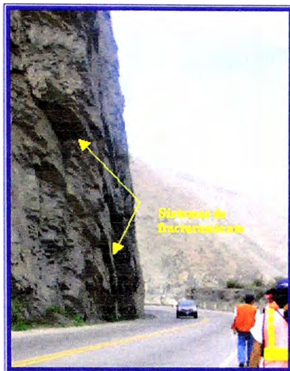
FIG N°6 La roca que caracteriza este sector es la andesita. El corte del talud sigue la misma inclinación del talud de los sistemas de fracturamiento. El desprendimiento de los bloques de roca es inminente en este sector .(KM 58+200)
