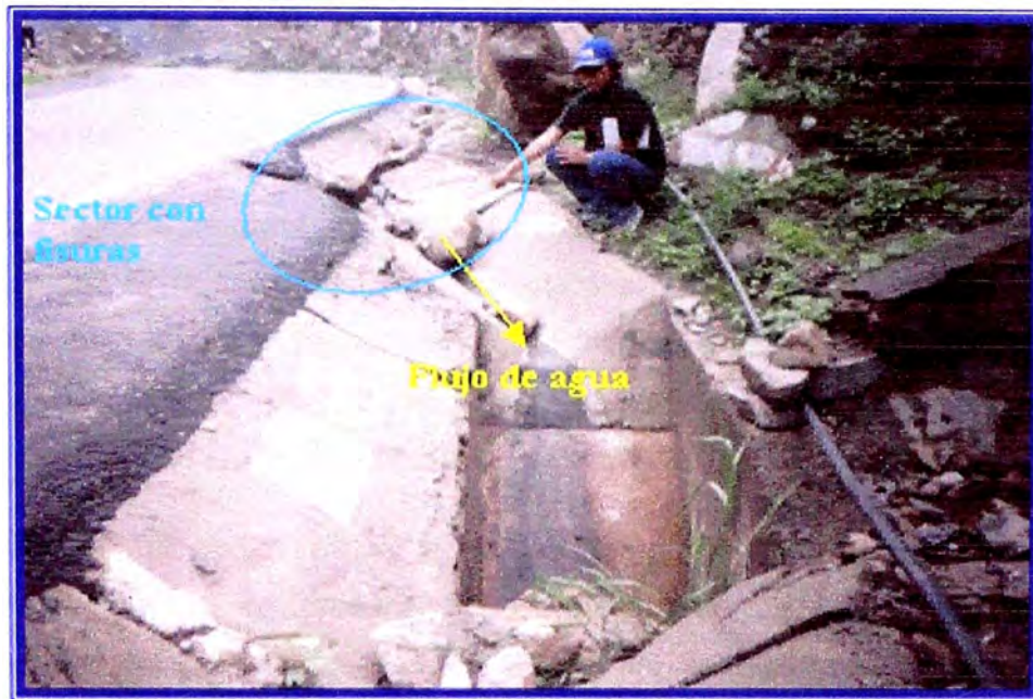
FIG N°9 Evaluación de obras de arte como cuneta , alcantarillas obras de encauzamiento, en la vista se aprecia la cuneta obstruida ( Km. 59+695 y Km. 59+440).
