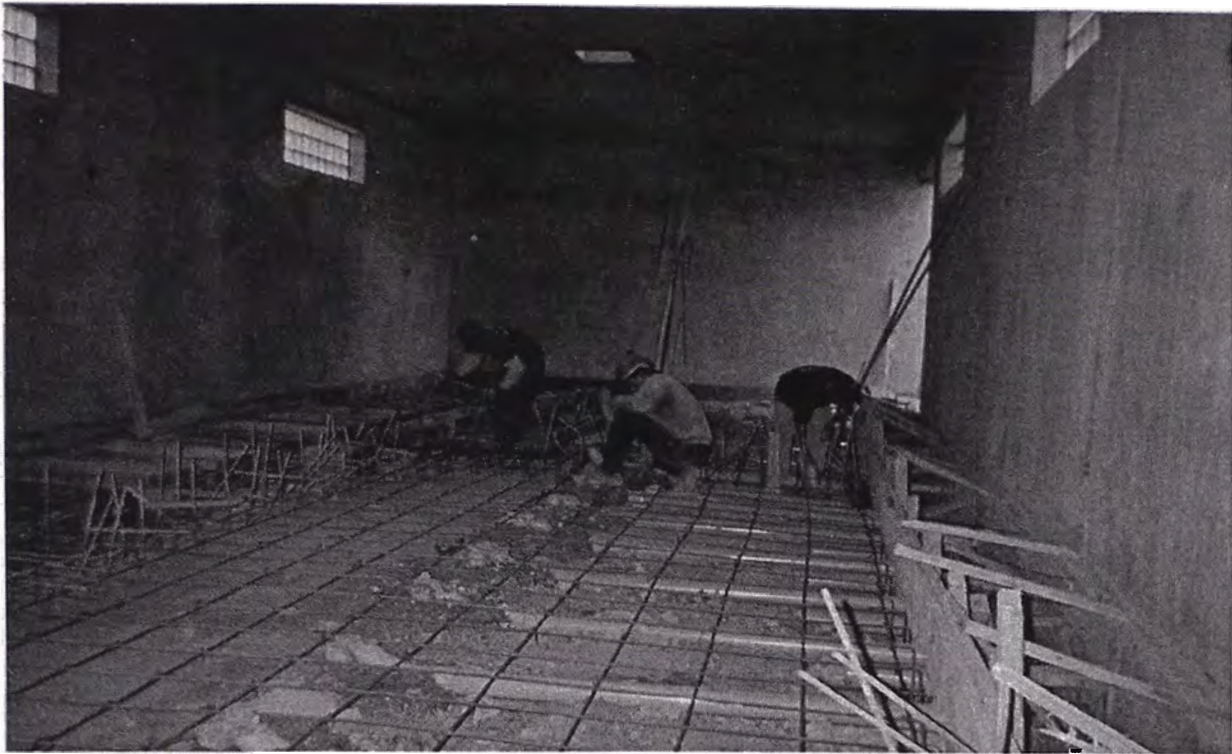
51. Vista izquierda, corresponde a ductos de ingreso a semisótano para cables 10kV; en el sector derecho observamos comunicación PVC3" hacia canaletas exteriores para futuras bases de celdas de alimentadores
