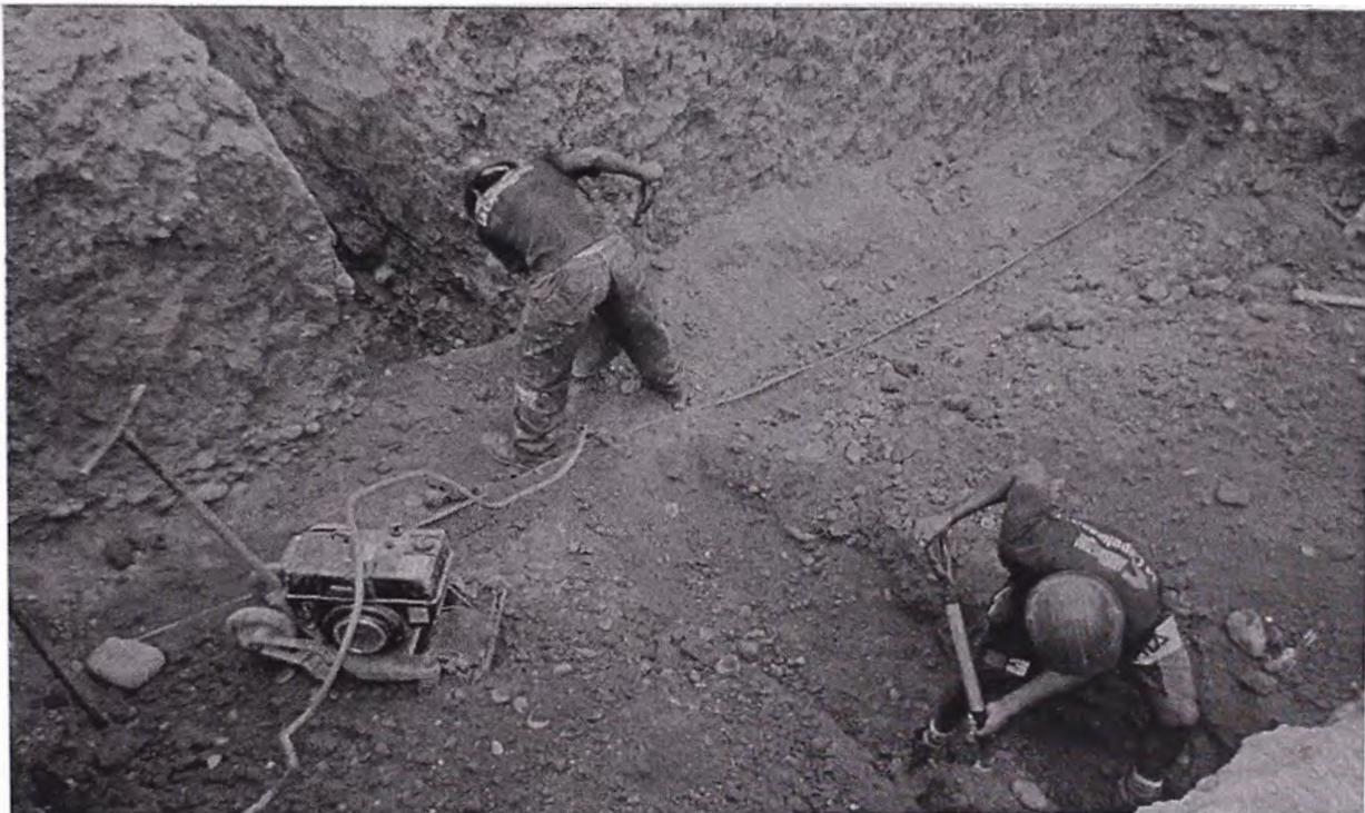
14. Excavación puntual, de tramo de línea a tierra que pasa por debajo de base de celda AT; el relleno posterior se realiza con bloque de ciclópeo envolvente a trenza.
