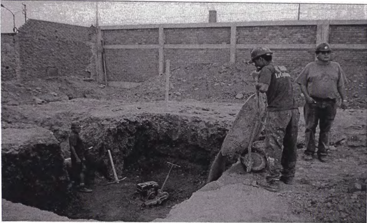
13. Perfilado de fondo y costados de base típica para equipo AT (celda de línea)
