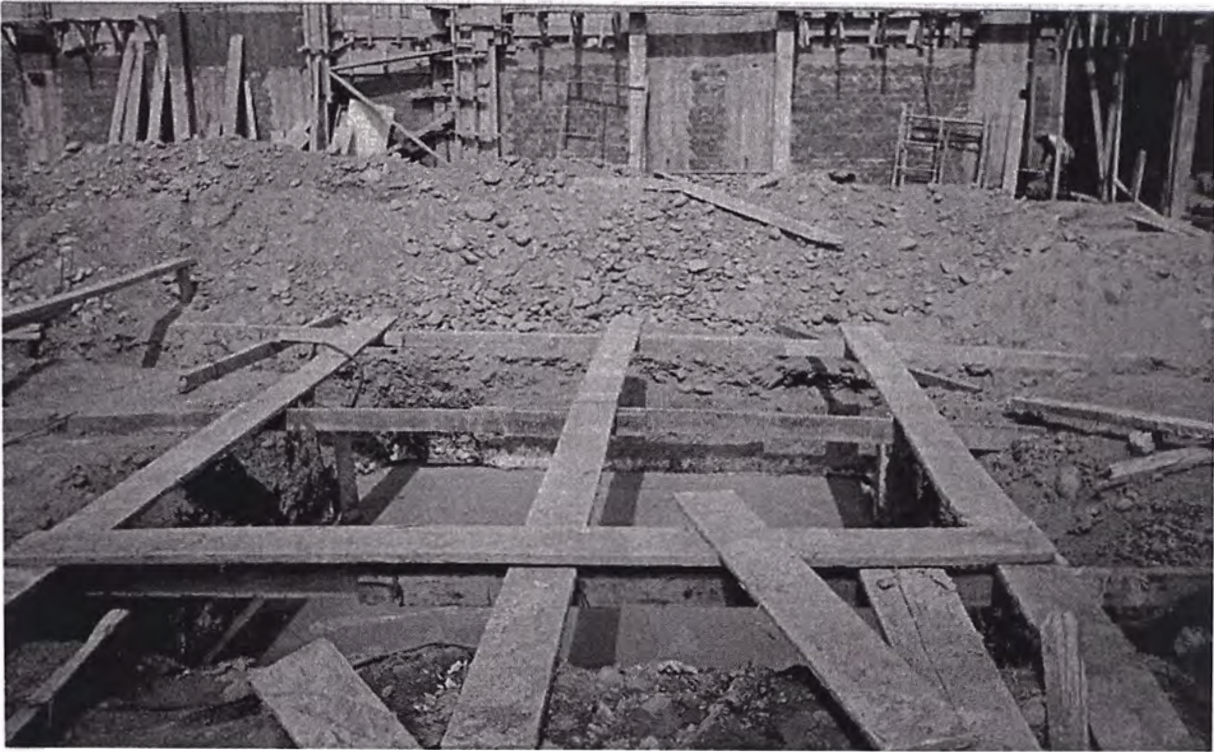
17. Vaciado de falso cimientado de concreto ciclópeo ( h=0.80\text{m} ), correspondiente a base de celda del transformador.; posteriormente se ejecuta la zapata y luego pedestales.
