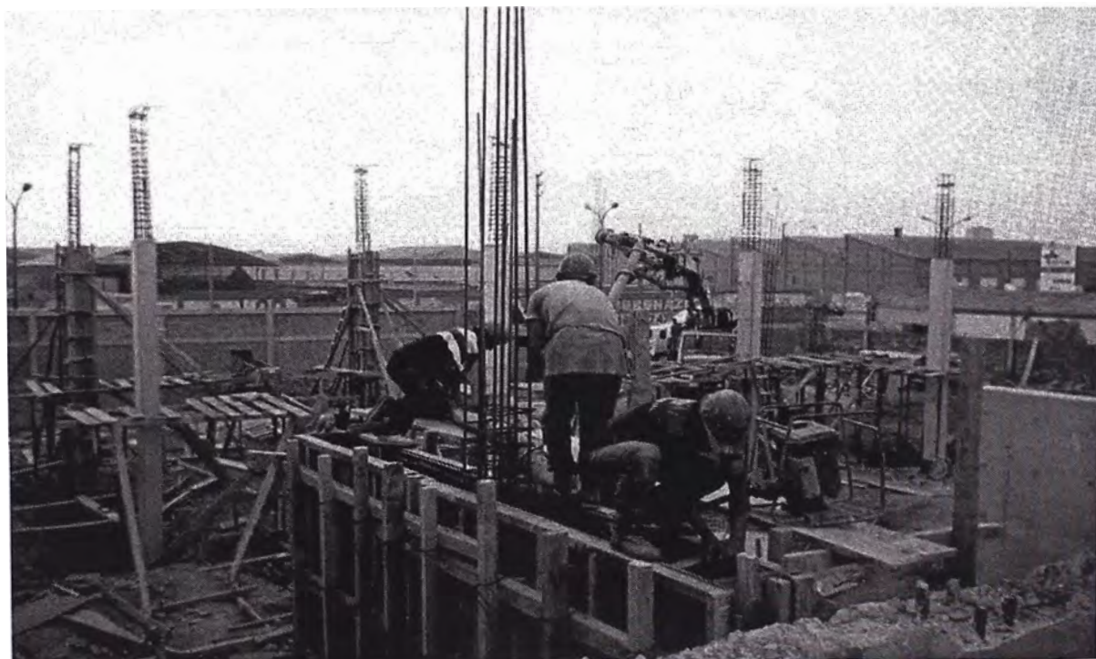
35. Verificaciones y ajustes previos al vaciado de pantallas separadoras; parte posterior ubicación de bomba impulsadora de concreto para el vaciado continuo.
