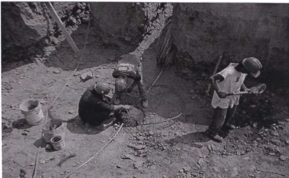
15. Operarios realizando empalmes de derivación en trenza superficial (-1.80m) de Sistema de Malla a tierra (zona contigua a base de equipos).
