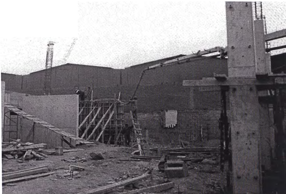
36. Vaciado de concreto premezclado f_c=210\text{kg/cm}^2 para placa (04) entre transformadores. Se requiere vaciado continuo en cada placa.
