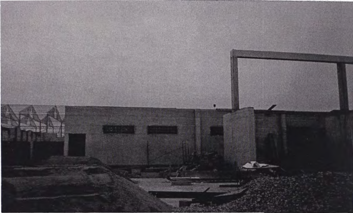
53. Fachada exterior de Edificio de celdas, incluye colocación de blocks de vidrios : en la parte derecha se aprecia el pórtico de llegada.
