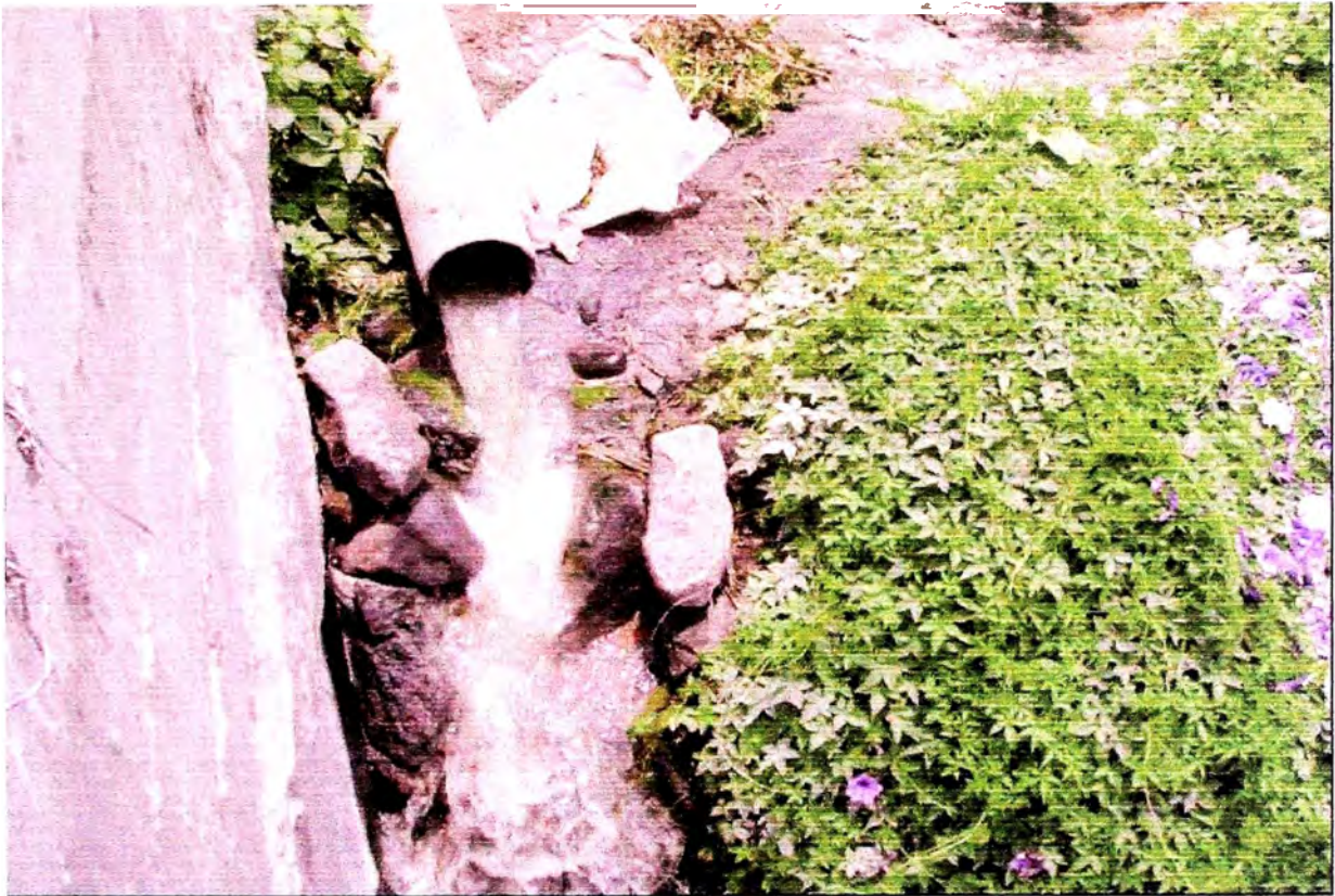
FOTO 3.-Tubería de rebose de la estación de bombeo existente
