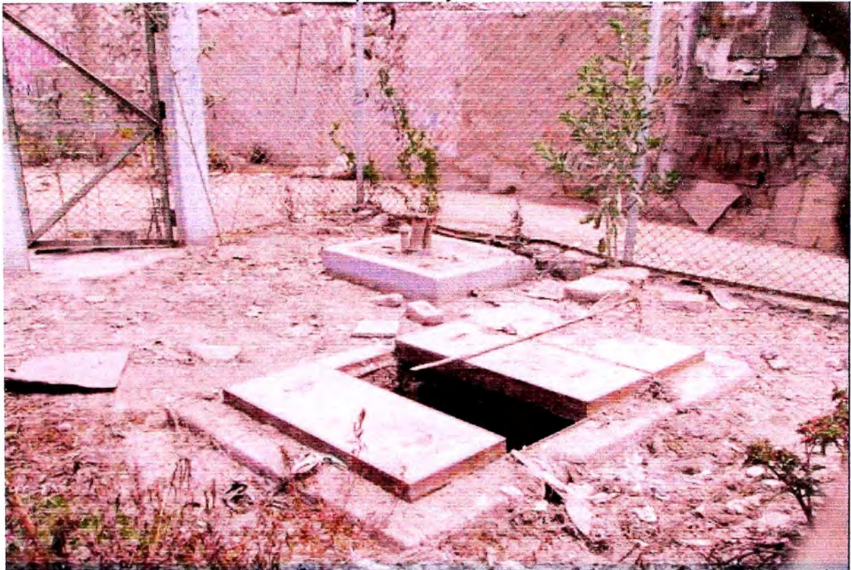
FOTO 5.-Estación de bombeo inoperativa y en estado de abandono
