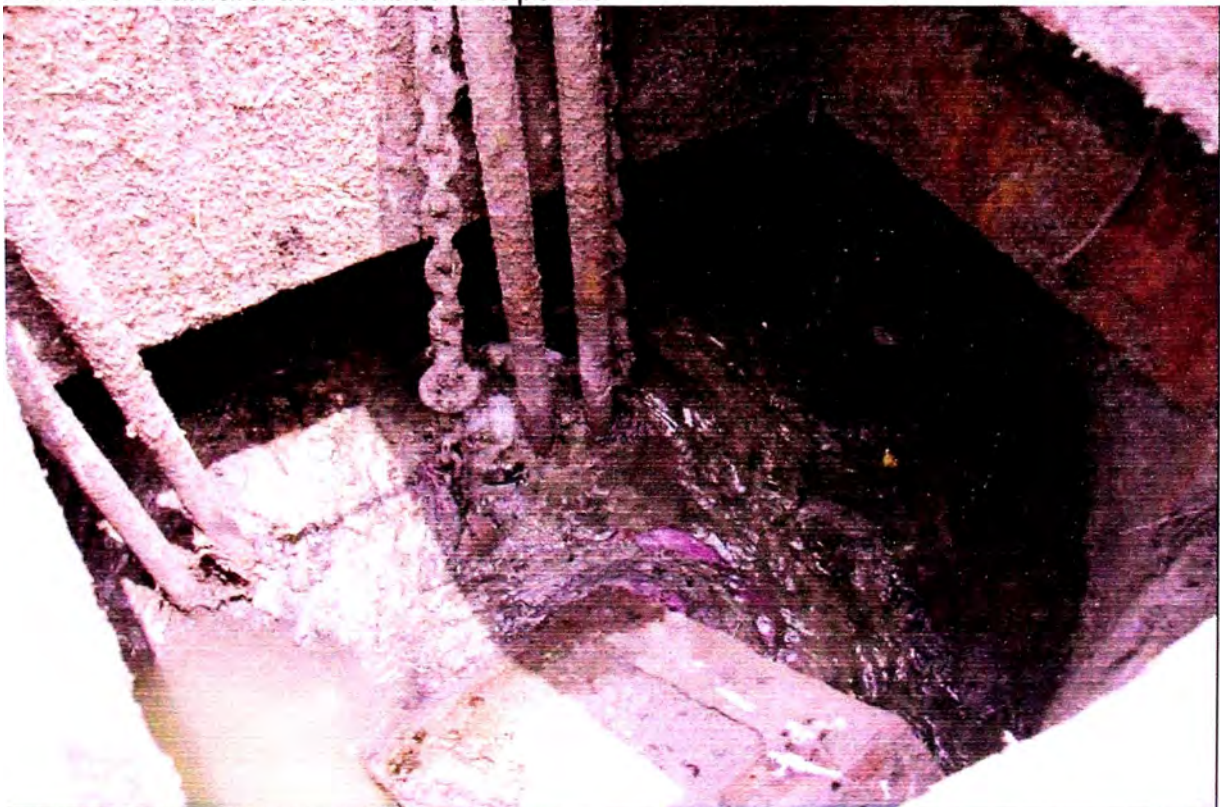
FOTO 6.-Cámara de bombeo colapsada
