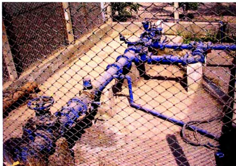
FOTO 10 BATERIA DEL POZO DE AGUA
