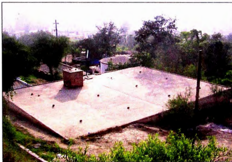
FOTO 1.4: TANQUE DE ALMACENAMIENTO DE AGUAS SUPERFICIAL
