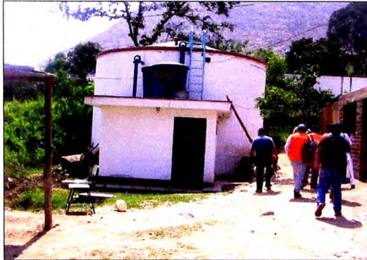
FOTO 11 TANQUE DE ALMACENAMIENTO DE AGUA SUBTERRANEA
