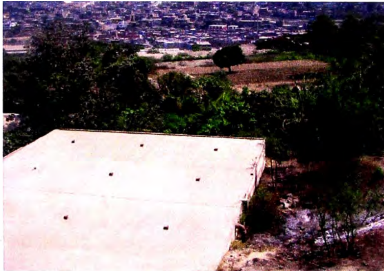
FOTO 09 TANQUE DE ALMACENAMIENTO DE AGUAS SUPERFICIAL
