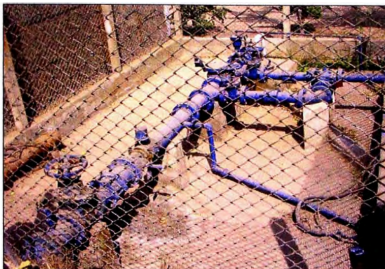
FOTO 2.0 BATERIA DE POZO
