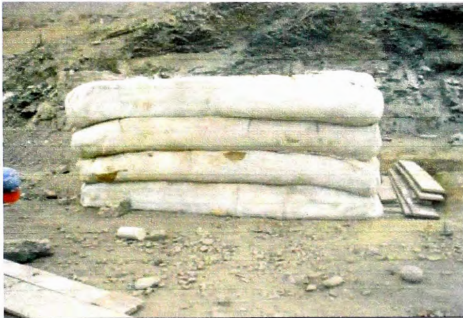
Foto A.1. (14) Vista del muro reforzado, se observa la falta de una mejor compactación en las esquinas.
