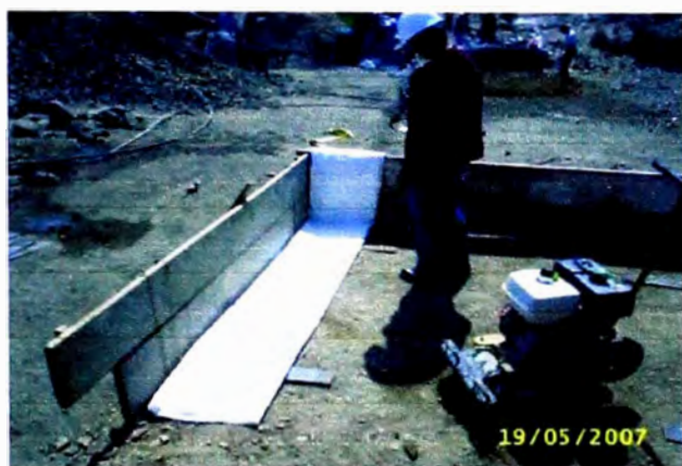
Foto 3.5. Colocación del geotextil en el interior del encofrado como elemento de refuerzo.
