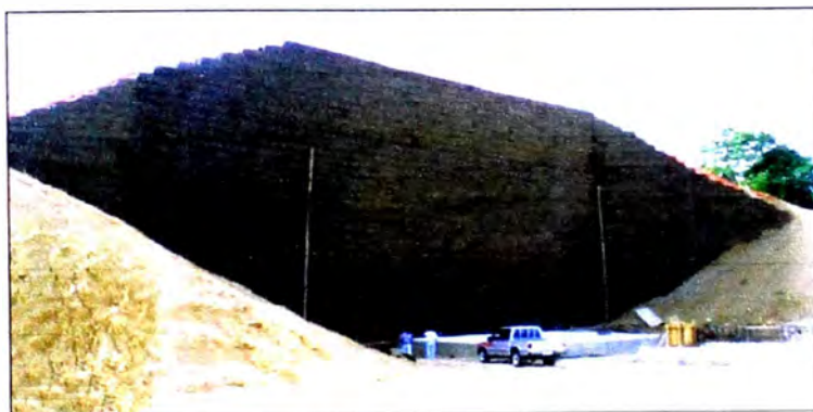
Foto 3.12. Muro de suelo reforzado protegido con malla electro soldada Mina San Martín - Honduras.
