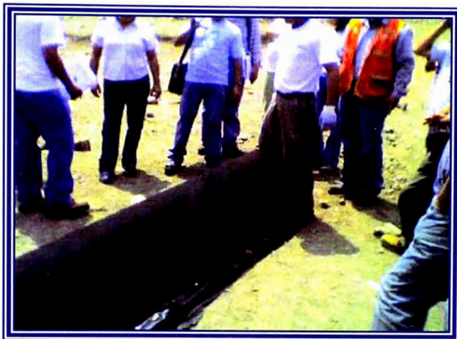
Foto 7: Colocación del Geotextil No Tejido sobre una superficie lisa (empaque plástico del geotextil) sobre el terreno.
