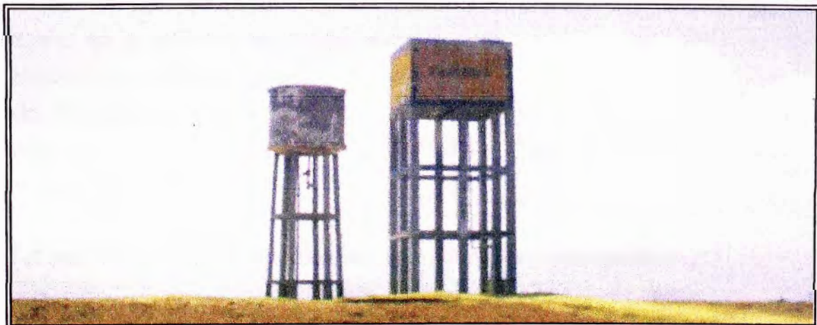
Foto N° 31 Tanques de Agua en el anexo de Huancas, solo uno esta operativo.
