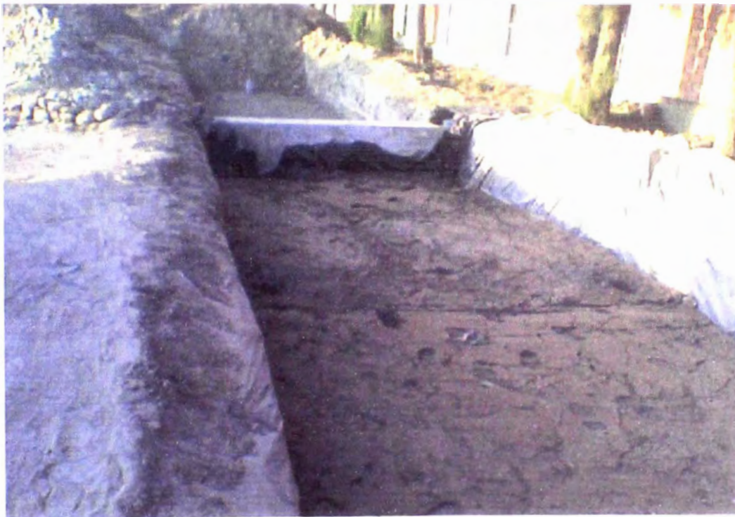
Foto N° 26: Subrasante de baja capacidad de soporte generado.
