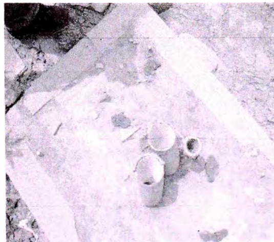
Foto N° 02: Se observa el estado en que se encuentra parte sus instalaciones.
