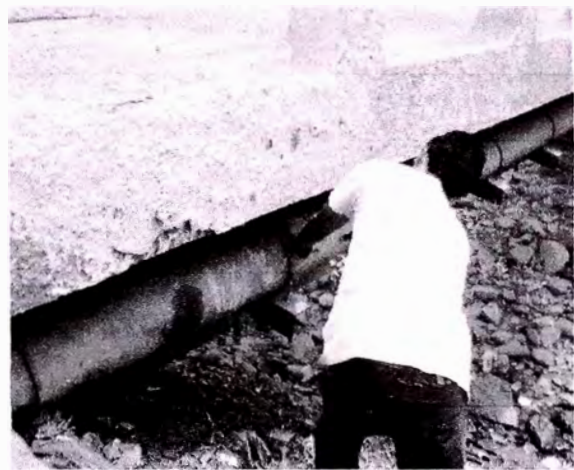
Foto N° 04: Se observa el estado en que se encuentra la tubería , se da golpes con un martillo.
