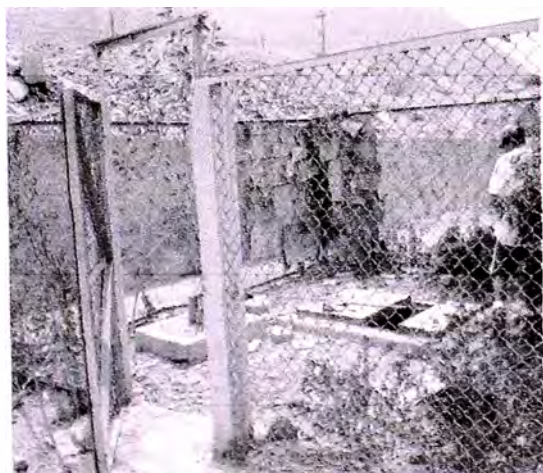
Foto N° 01: Se observa la estación de bombeo existente, el cual se encuentra deteriorado.
