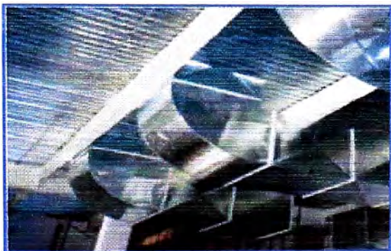
Foto 2.12: Ductos de aire acondicionado
