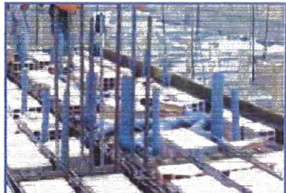
Foto 2.2: Instalaciones en losa aligerada
