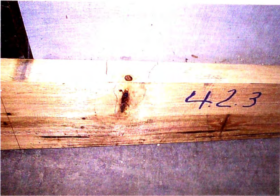
Viga no clasificada: Nótese el tipo de falla que acompaña a la zona del nudo.
