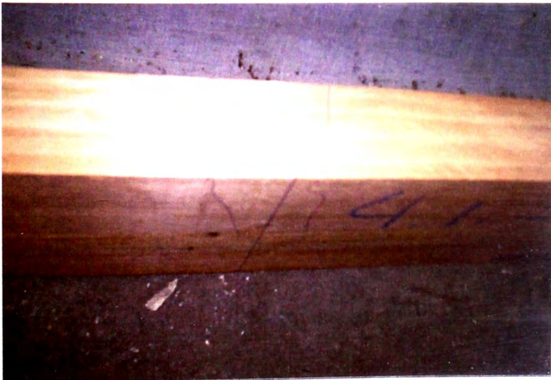
Viga no clasificada: Las huellas de las fallas por compresión eran casi imperceptibles después de los ensayos.
