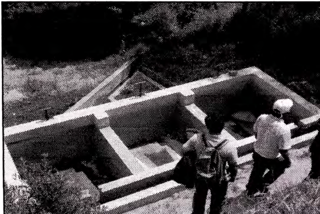
Desarenador de la UNE para agua de canales, para su tratamiento
