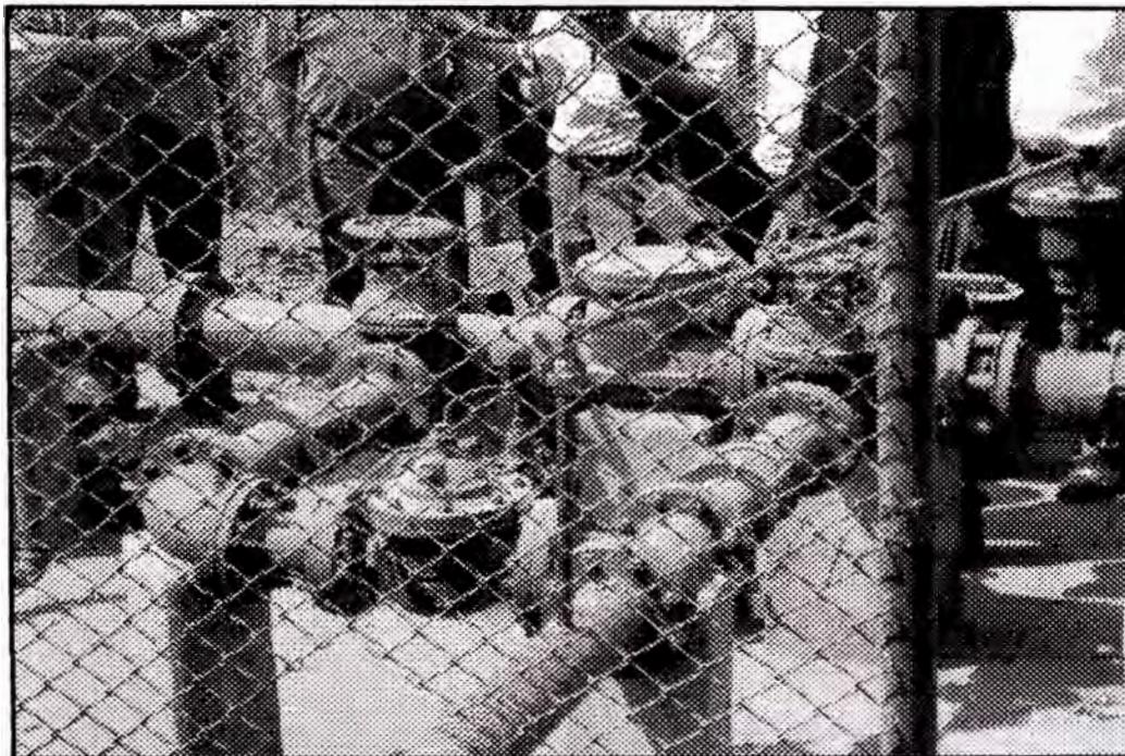
Sistema o árbol de succión agua subterránea, se encuentra en la UNE, en la entrada principal a la derecha aproximadamente a unos 40 metros Fotografía 2.4 Fecha 21-09-07
