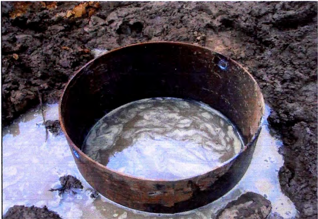
5.- AFLORAMIENTO DE LA NAPA FREÁTICA EN EL POZO EXCAVADO
