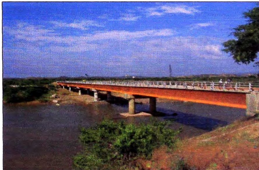
Foto IV-13: Estado Actual del Puente Franco.
