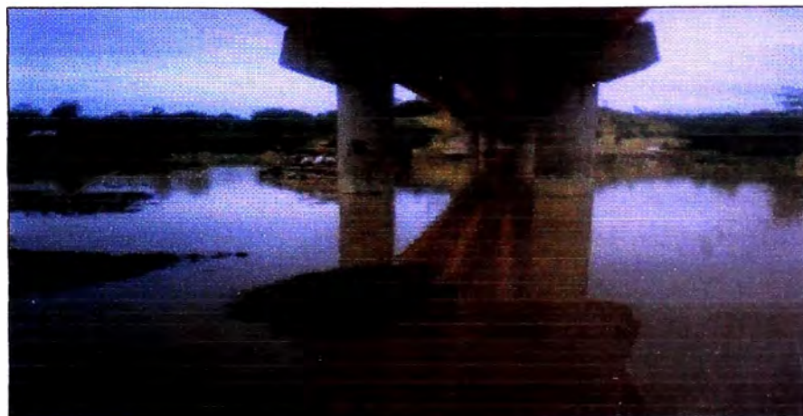
Foto IV-11: Inundación de zona de trabajo por crecida del río.
