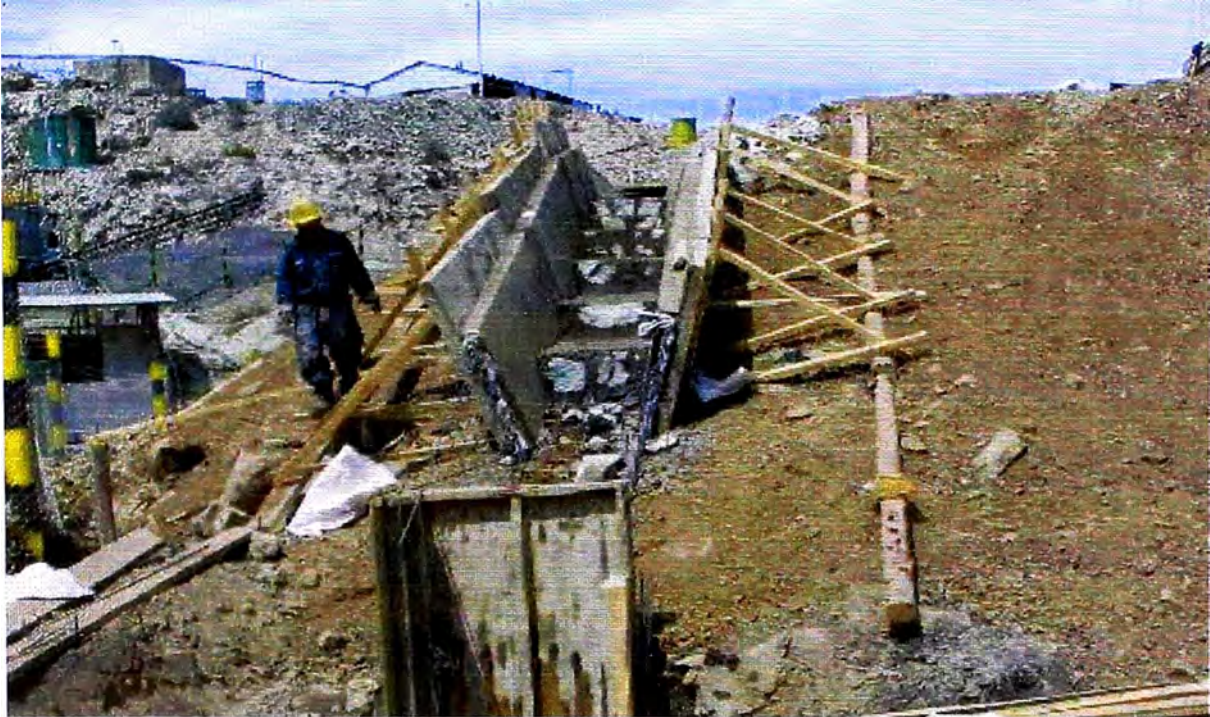
FOTO N° 30: Estructura hidráulica para descender al nivel de carretera a continuar con el canal de coronación paralelo a la carretera.
