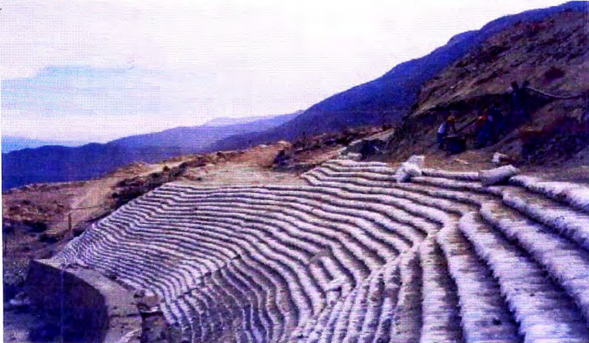
FOTO N° 07: Perfilado de talud en forma manual, haciendo uso de sacos de polietileno, se observa también el muro construido con anterioridad.
