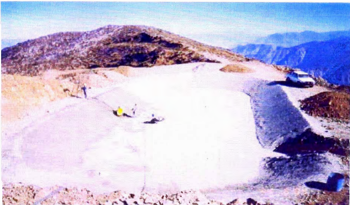
FOTO N° 40: Compactación de la cama de apoyo, al lado derecho se observa una excavación donde se colocaría la tubería e captación.
