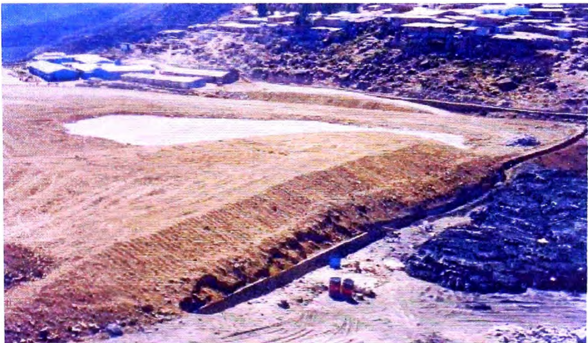
FOTO N° 29: Canal en la zona de limite, entre el área de cierre y la de operación de los relaves de cianuración.
