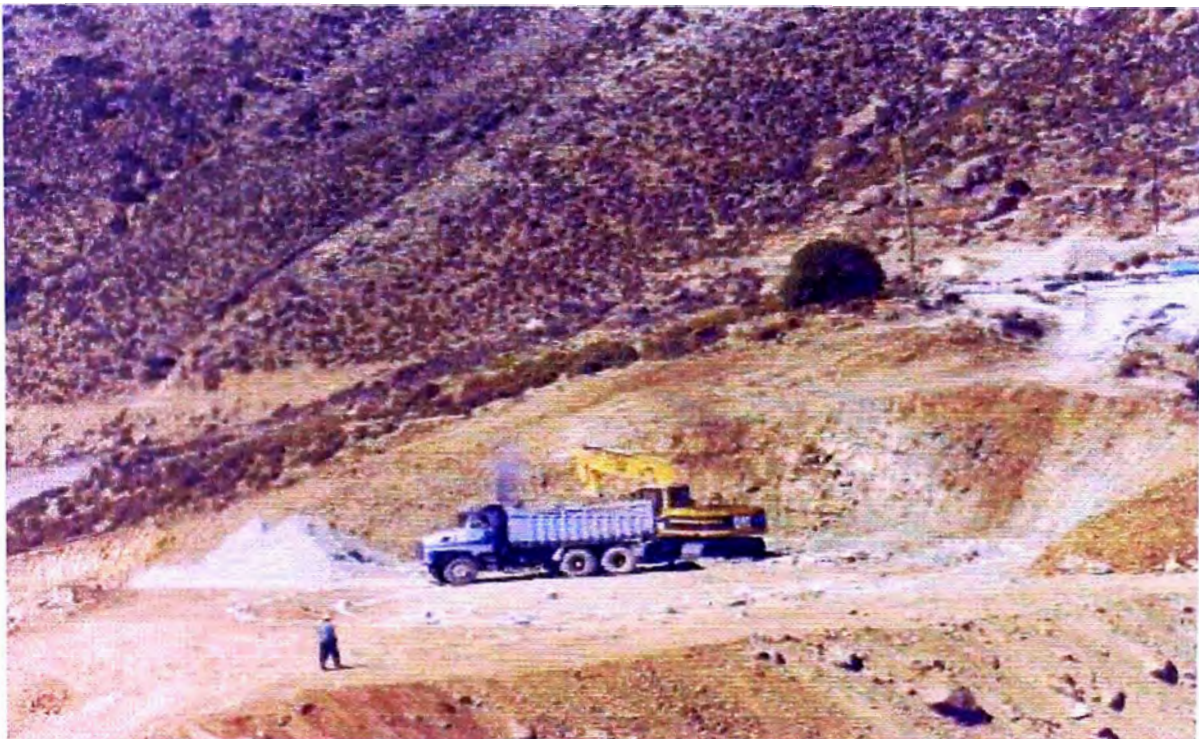
FOTO N° 36: Replanteo una vez nivelada la parte superior para el reservorio, de este nivel se procederá a excavar el replanteo.
