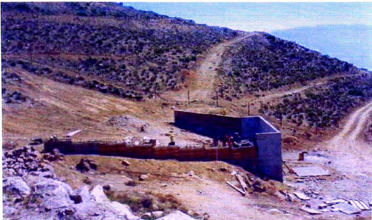
FOTO N° 06: Planta de relleno hidráulico, en nueva ubicación, se tomó como base la existente.
