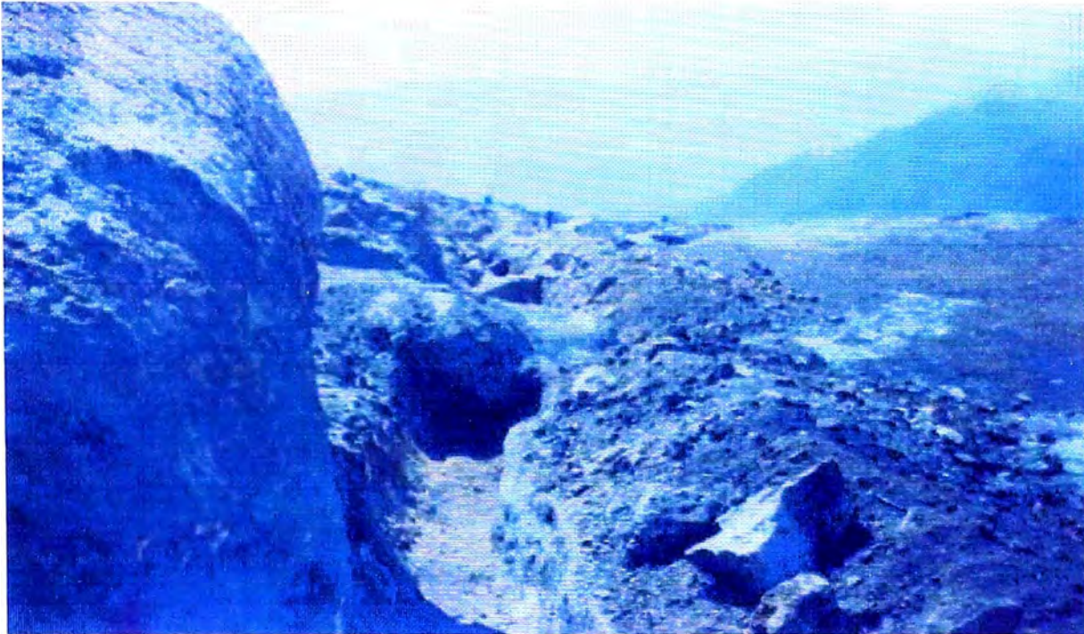
FOTO N° 24: Excavación del canal, por la zona existían rocas en el trazo, se hizo uso de explosivos en algunos tramos.
