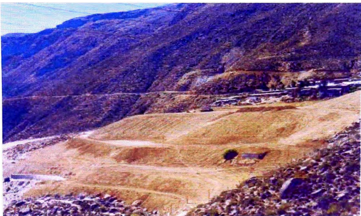
FOTO N° 18: Dique terminado y la cobertura del talud principal, se observa que la planta de Relleno Hidráulico quedó inutilizada.
