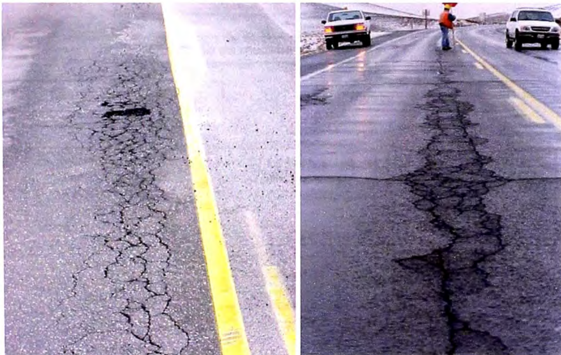
Figura 2.2.- Fallas y grietas localizadas causadas por stripping.
