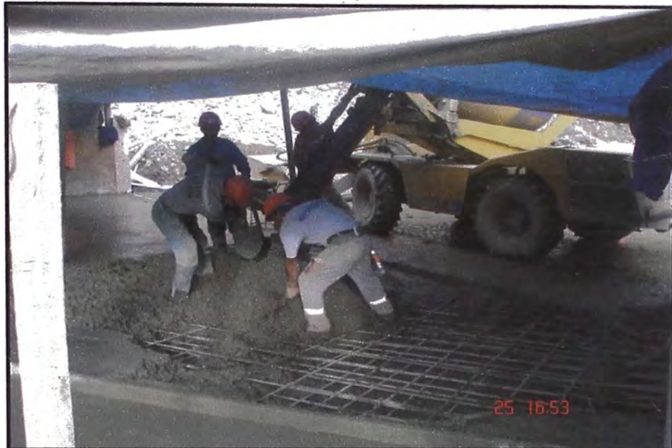
VACIADO DE CONCRETO BAJO TOLDO PARA PROTEGER EL CONCRETO DE LA LLUVIA
