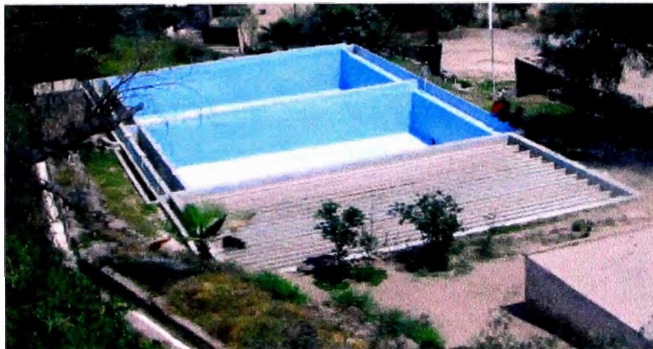
Foto N°5.- Flocculador de flujo horizontal y Decantadores estáticos (2)
