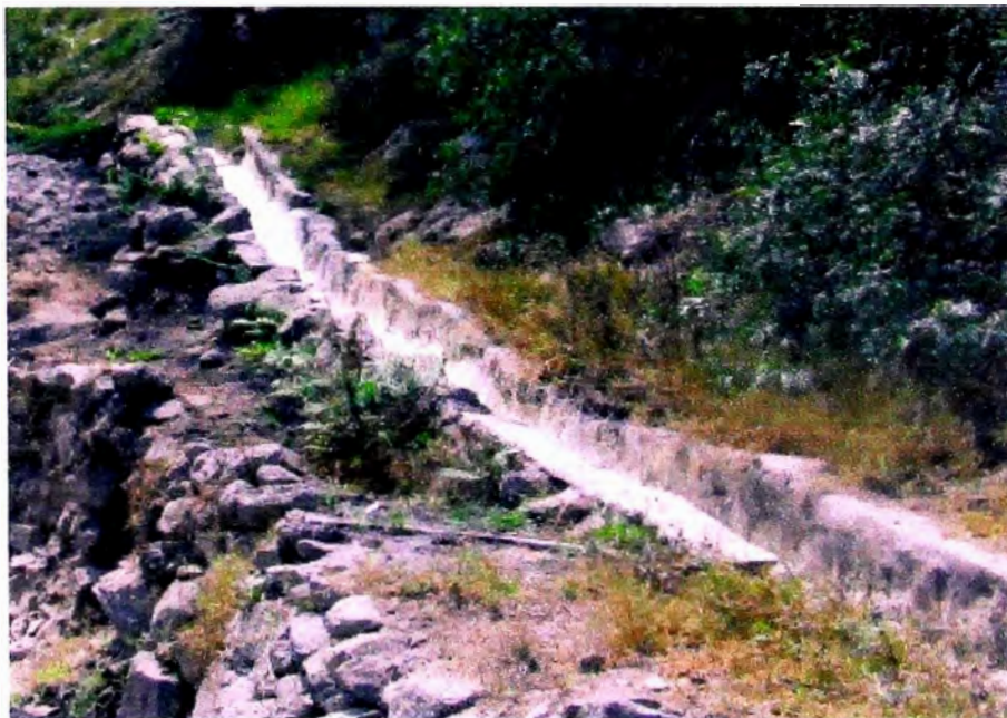
Foto N°4.- Canal de Conducción desde los desarenadores al floculador
