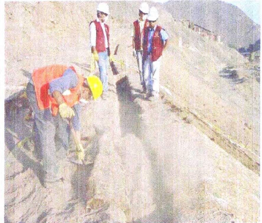
Foto 8: Relleno de zanja de anclaje superior con material excavado previamente de la misma zanja.
