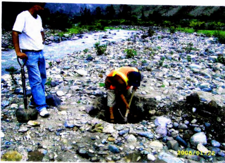
FOTO N° 3.- EXCAVACIÓN DE CALICATA PARA TOMA DE MUESTRA DE CANTERA DE MATERIALES (SE TOMA EN CANTERA HUARIQUIÑA, EN EL RÍO RÍMAC)
