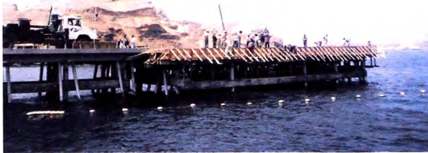
FOTO N° 09: Vaciado de concreto en vigas longitudinales, transversales y losa en la zona del cabezo del muelle.
