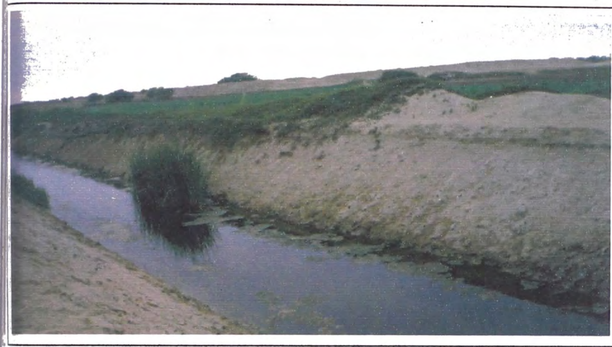
FOTO N°9 Vista del dren próximo a la zona de estudio. Se aprecia el material deleznable, con la humedad se va erosionando (carcomiendo) y deslizando.
