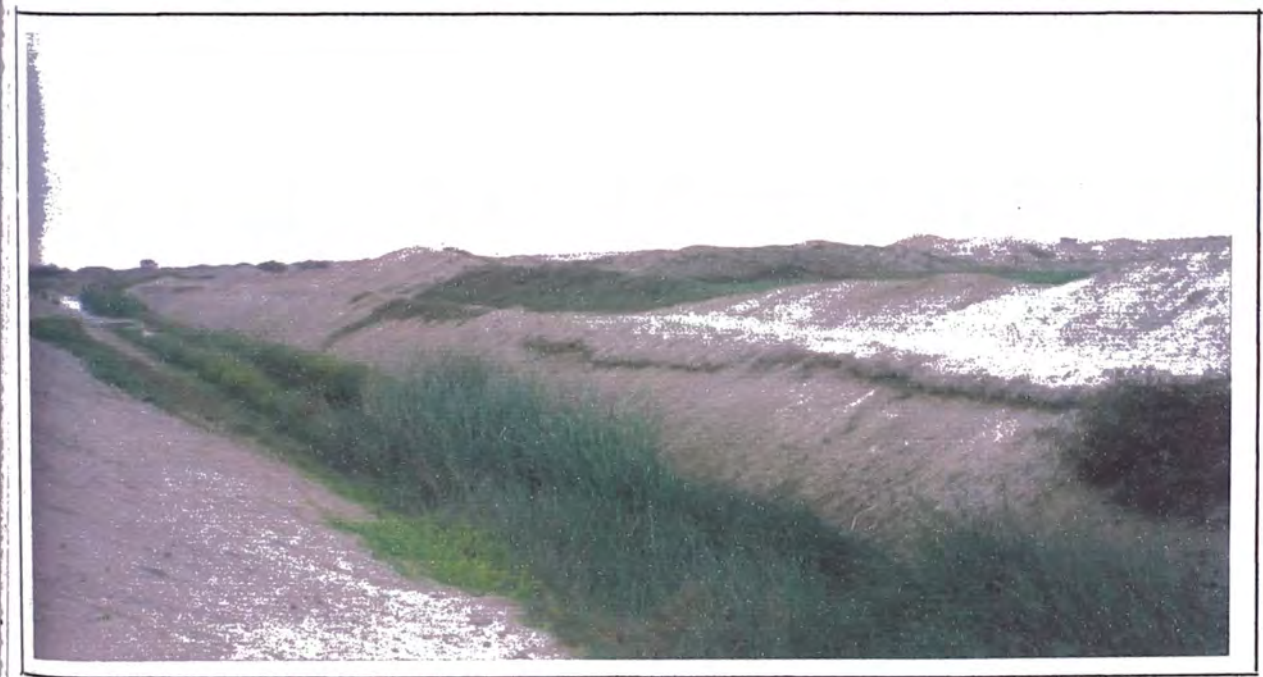
FOTO N° 10 Vista desde del mismo canal, donde la zona deleznable es mas Pronunciada.
