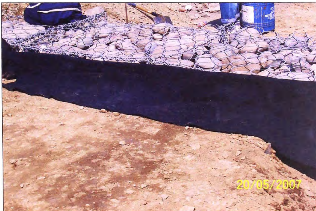
Foto 24 – Doble en borde superior de geotextil no tejido.
