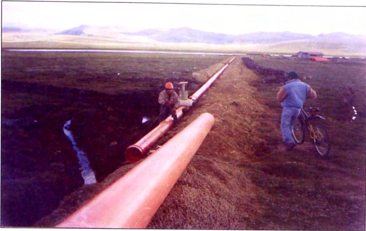
Foto 5: Intercambio de excavación de zanja a terraplén artificial. Se observa el desvío de las aguas subterráneas mediante dren francés, a un canal natural a la izquierda. El canal emisor está conformado de tuberías UPVC-UF de 12" en todo el tramo.
