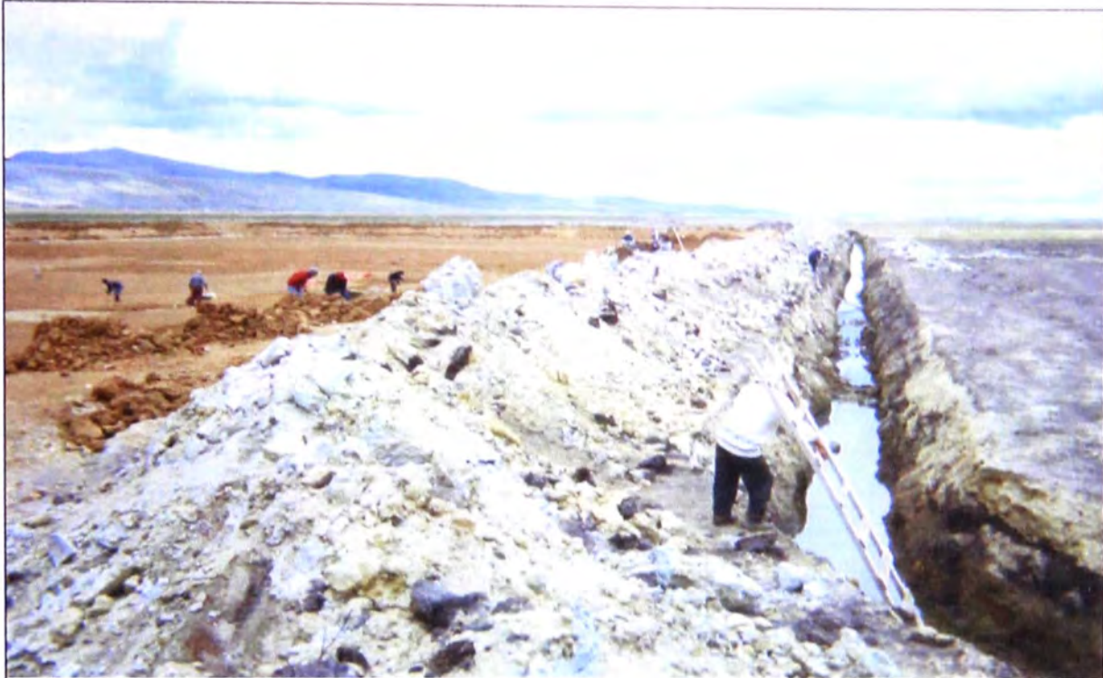
Foto 29: Canal de Drenaje Mayor en el lado derecho de la laguna, con cola de fondo por debajo del fondo de la laguna, a fin de cortar el nivel freático alto.
