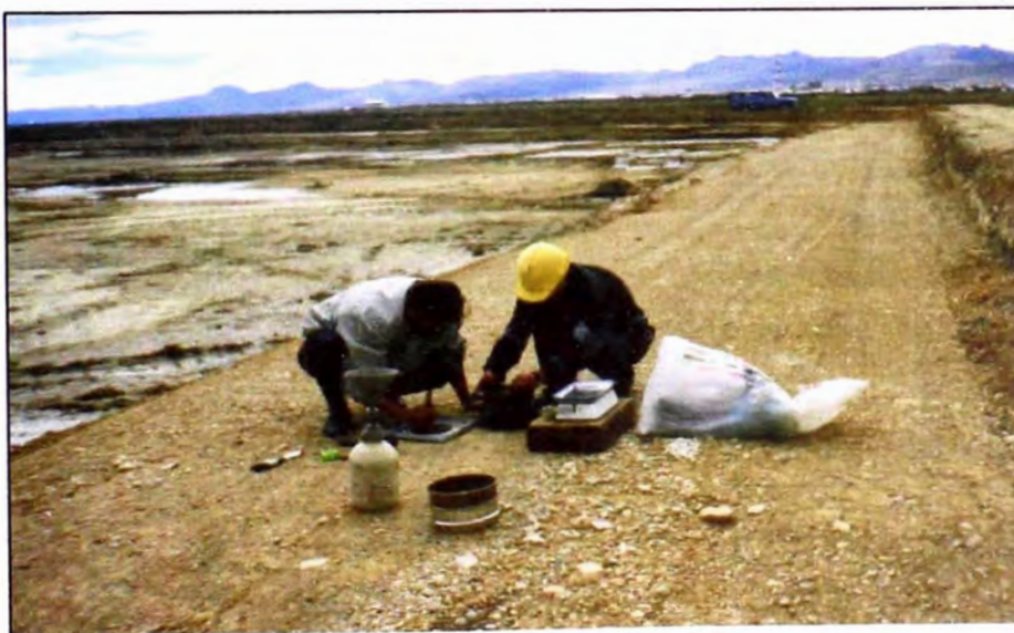
Foto 18: Ensayo de densidad realizado in situ, sobre el terraplén sur de la laguna Primaria, por el Técnico Laboratónsta.
