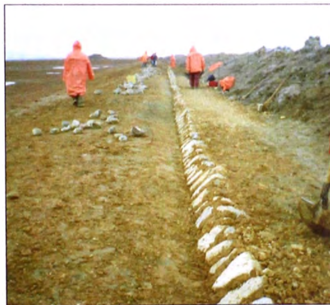
Foto 30: Cunetas artesanales al borde derecho de la corona de la laguna primaria.
