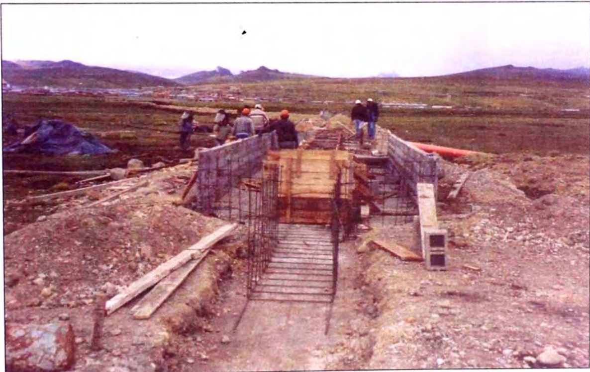
Foto 11: Los muros y demás elementos de las estructuras de concreto fueron construidos por partes mediante el encofrado de sus elementos y el vaciado de concreto de f_c = 210 \text{ kg/cm}^2 preparado en sitio con una mezcladora con tolva. Se observa el acarreo de concreto con latas y la verificación de labores por parte de la Supervisión.
