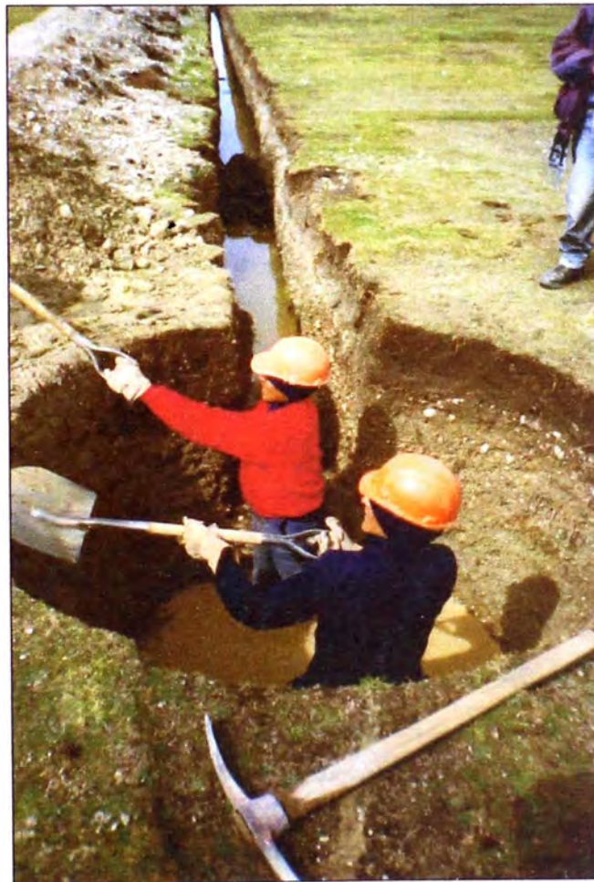
Foto 4: Se observa la excavación manual de buzones, con un diámetro de 1.60 metros. Se puede apreciar la capa superficial de material orgánico, seguido de material gravoso, y el alto nivel freático de la zona.
