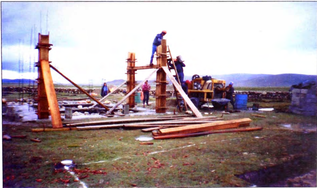
Foto 24. y aclado de columnas con concreto f_c=175 \text{ kg/cm}^2 de la Caseta de Guardianía. Se puede observar que todo el material orgánico del área interior fue retirado, así como también el hito de concreto en el vértice exterior sureste de la laguna pmana.
