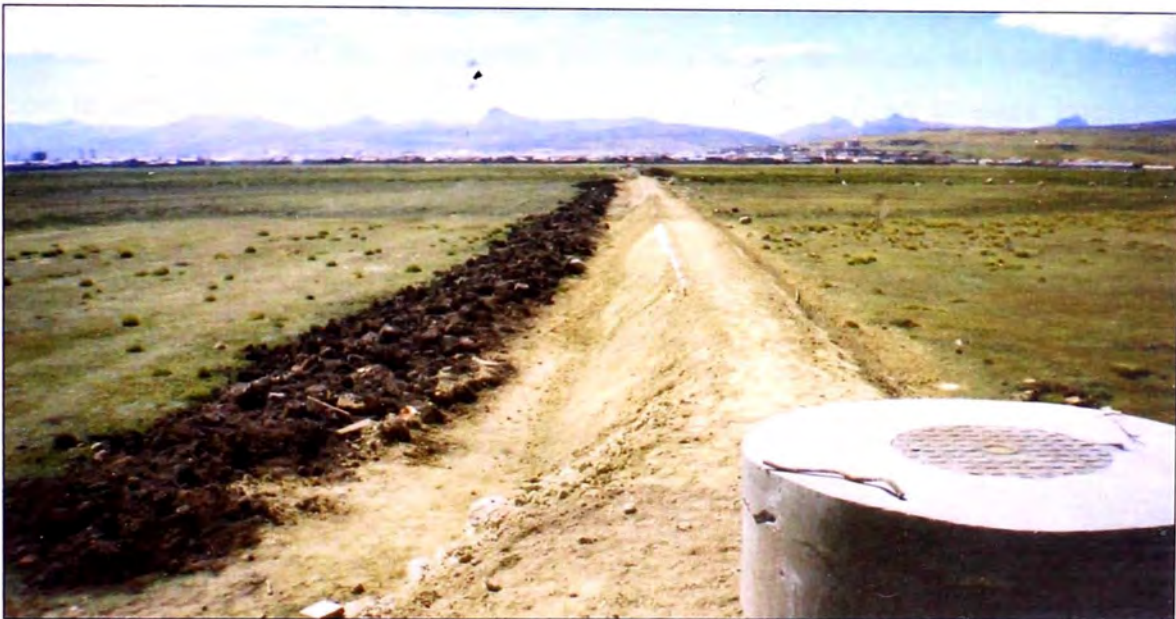
Foto 6: Línea emisor en el tramo sobre el terraplén artificial, rellena y compactada con material de préstamo. La capa orgánica será cubierta finalmente a fin de disminuir el impacto paisajístico.
