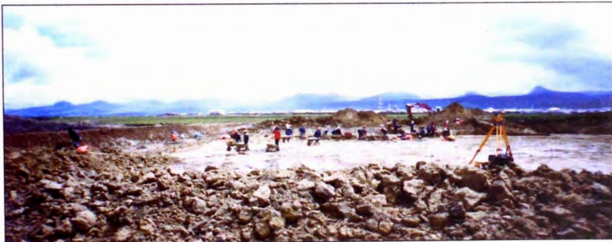
Foto 16: Corte de terreno en la Laguna Primaria en forma manual mediante cuadrillas de peones, quienes retinan el material excavado al borde de la laguna para ser eliminado con las maquinarias pesadas (Retroexcavadora y volquetes).
