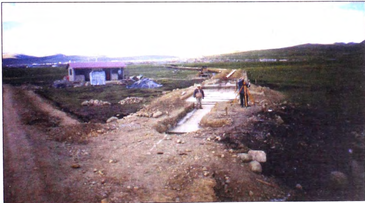
Foto 10: Solado de concreto simple de espesor de 10cm, sobre el cual descansarán las estructuras de concreto armado de pre tratamiento. Como se aprecia, el replanteo y nivelación es constante e importante durante el proceso, para lograr la precisión.
