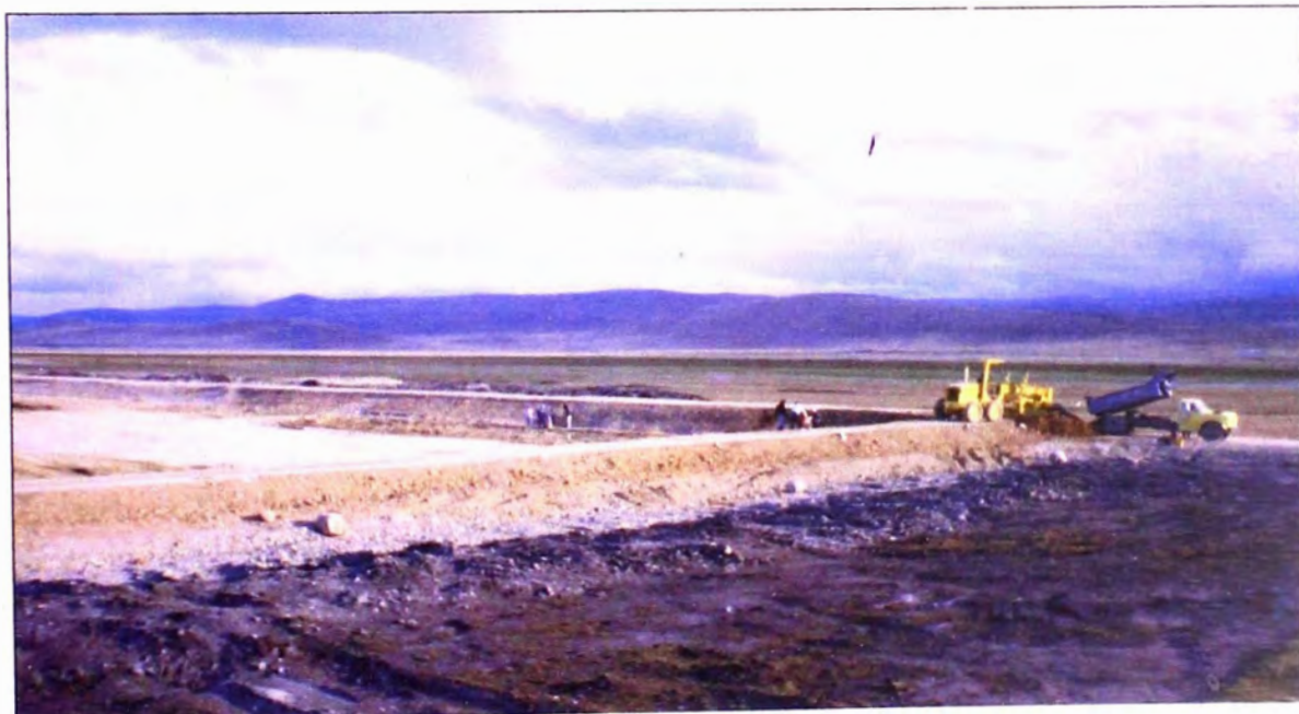
Foto 17: Construcción de los diques de la Laguna Primaria, se observa el tendido del material de afirmado sobre el material de grava en el fondo como cuerpo Y base.
