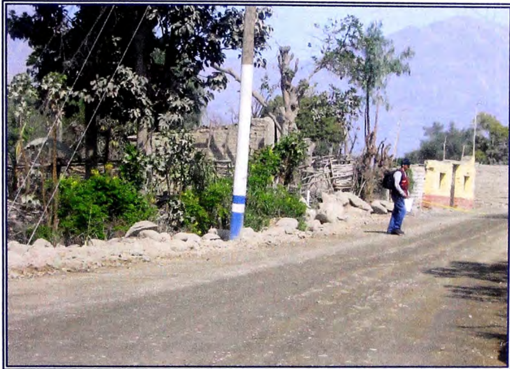
FOTO N° 1.- Nos ubicamos en la Progresiva 57+000 donde comienza el tramo, haciendo un levantamiento topográfico con wincha y GPS.
