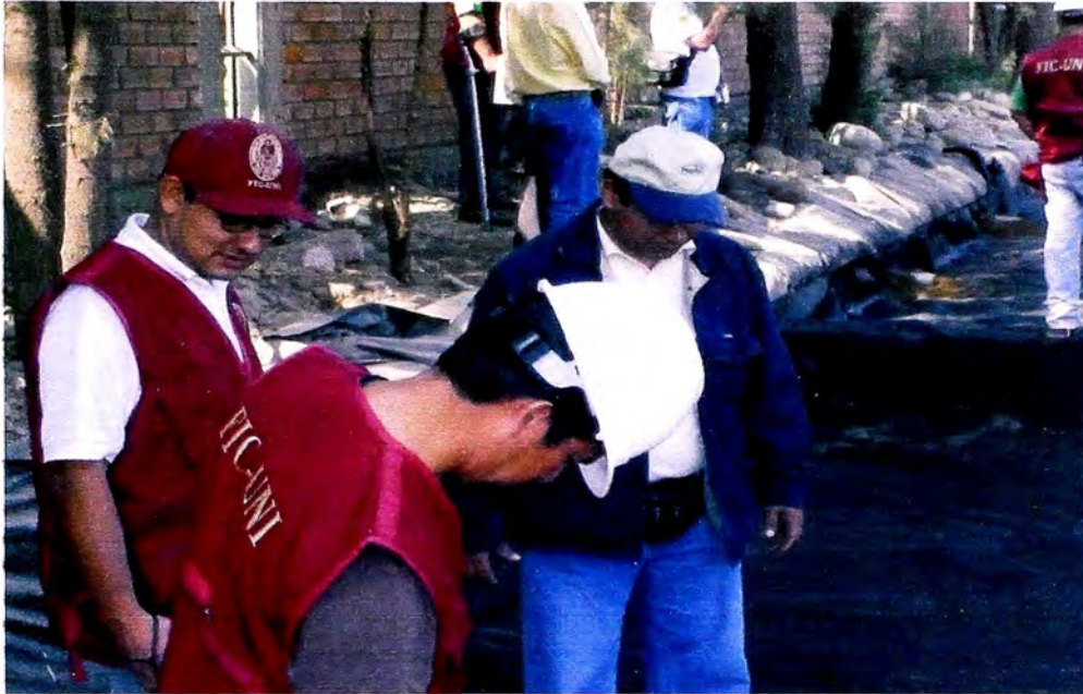
Foto 17. Comprobación física que el material de relleno sobresaturado tenía un valor de CBR < 1\%
