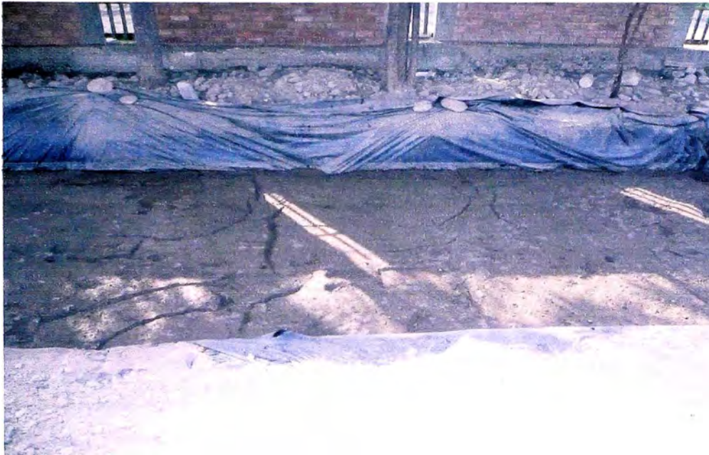
Foto 15. Relleno sobresaturado con un CBR<1%
