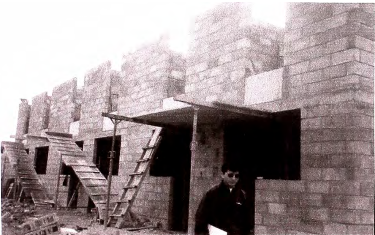
Foto.N°26: Proyecto Piloto Martinete – Sistema de Albañilería Armada (Nótese la gran cantidad de albañilería armada y las varillas verticales de acero )
