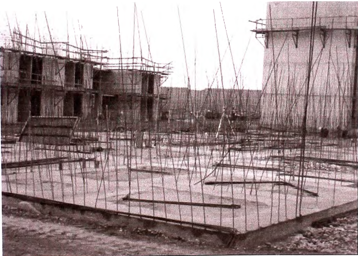
Foto.N°6: “Platea de cimentación para un bloque de 4 niveles” (Nótese las varillas de verticales de \varnothing 3/8 ”, en el perímetro de la losas)
