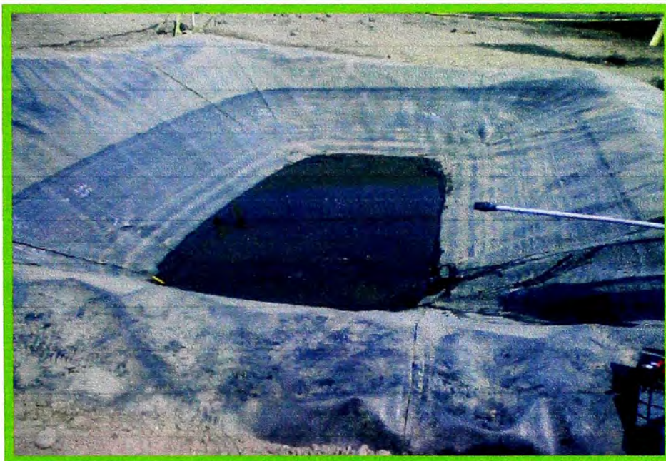
Foto N° 41: Nivel final de Reservorio N° 1, en la parte inferior, se observa la línea de succión con válvula de pie y canastilla para evitar ingreso de material sólido al sistema.
