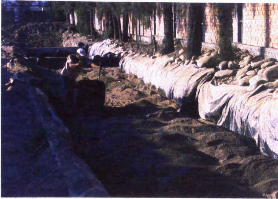
Figura 3: Personal colocando el material zarandeado en zona excavada. Se aprecia el revestimiento de plástico a usarse como impermeabilizante
