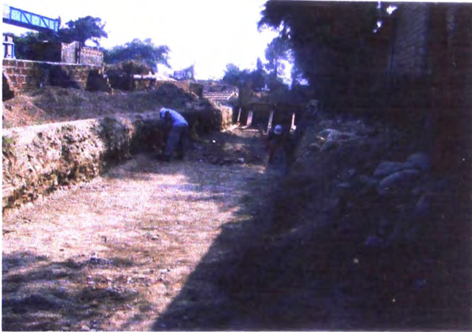
Figura 1: Zona de trabajo en donde se aplicará la geomalla Biaxial BX 1100. Se realizó excavación para colocar material con baja capacidad portante
