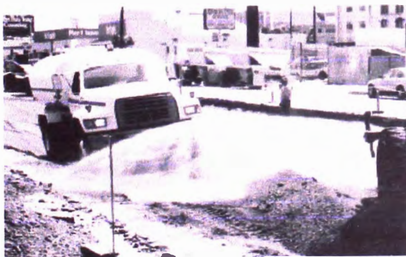
Figura 3.10.- Descarga de relleno de áridos encima de geomallas sobre una sub rasante blanda
