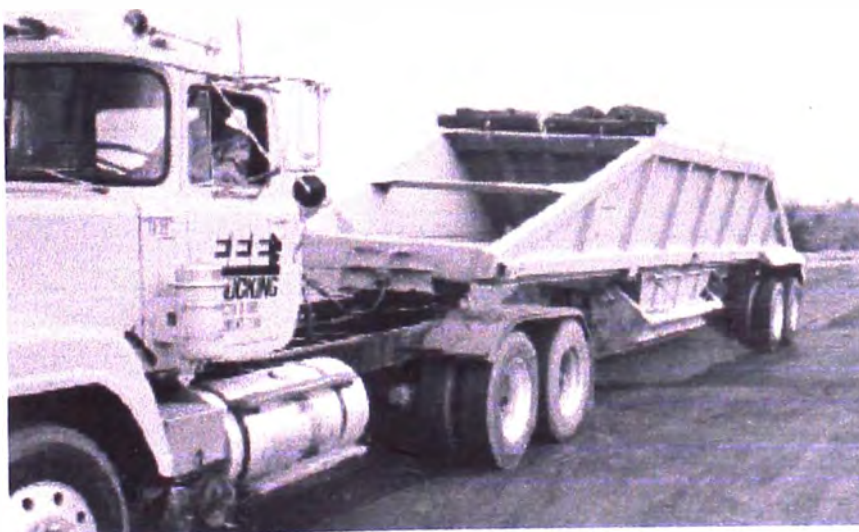
Figura 3.7: Descarga de relleno de aridos encima de geomallas sobre una subrasante CBR > 4
