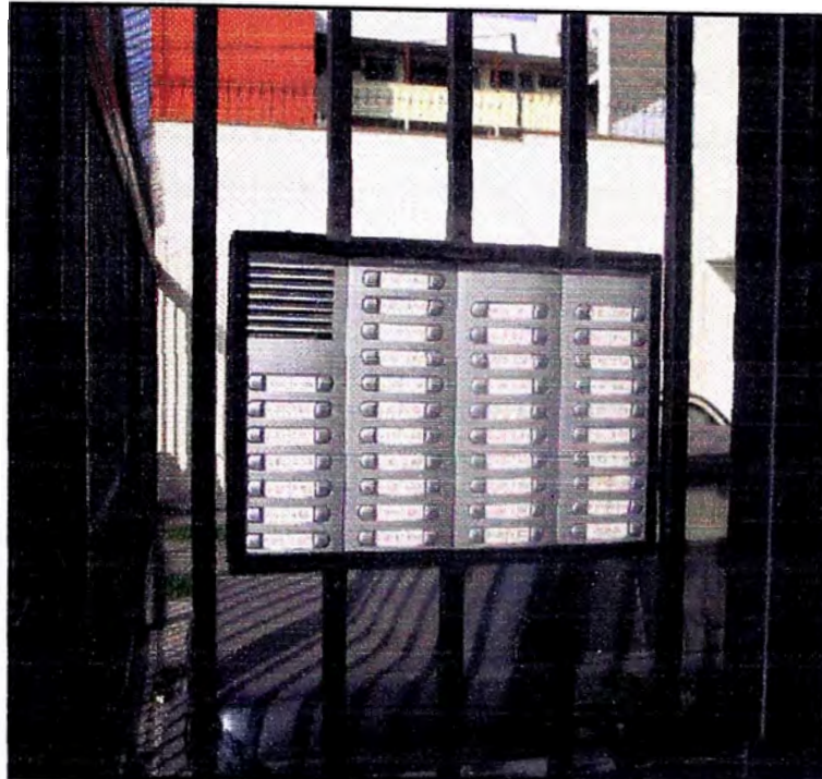
Foto N°3.3: Directorio de Teléfono Portero
