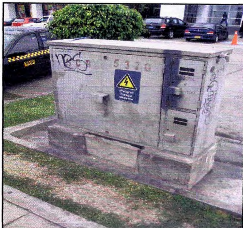
Foto N°2.3: Subestación Eléctrica: Tipo Bóveda
