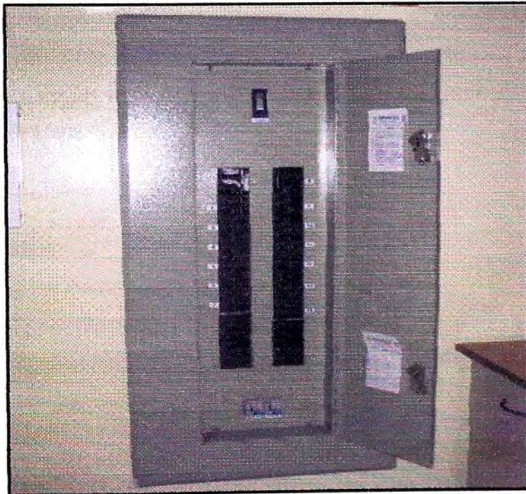
Foto N°2.10: Tablero Servicios Generales con sus Interruptores termomagnéticos
