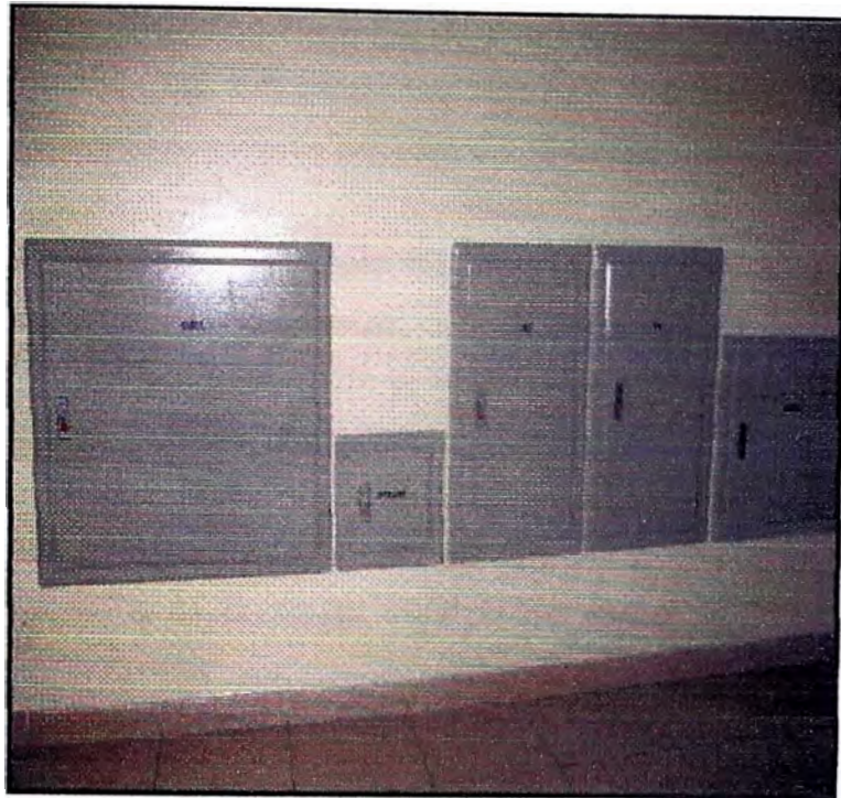
Foto N°2.6: Detalle de Cajas de Paso ubicado en el Pasillo de la Edificación
