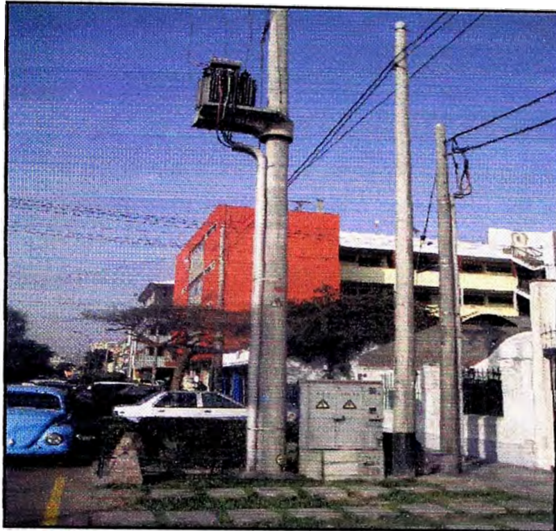
Foto N°2.2: Subestación Eléctrica: Tipo Pedestal
