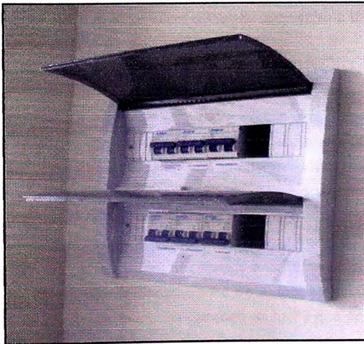
Foto N°2.7: Tablero de Distribución con sus Interruptores termomagnéticos
