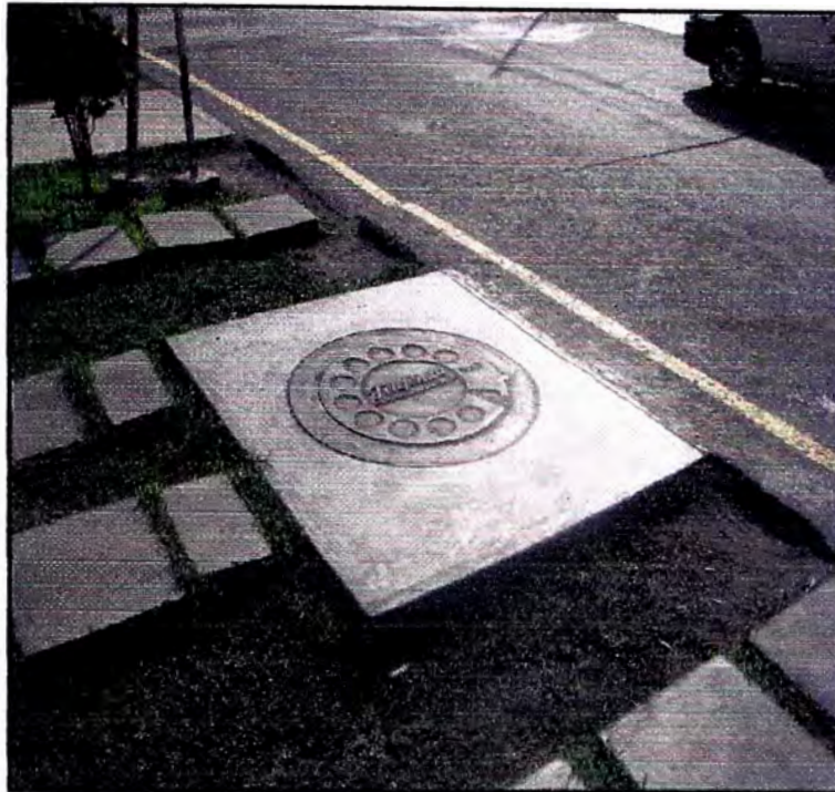
Foto N°3.1: Detalle de Buzón para comunicaciones
