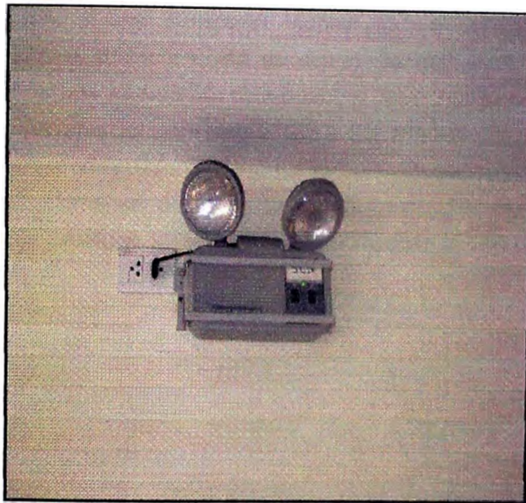
Foto N°2.9: Artefacto de Iluminación de Emergencia
