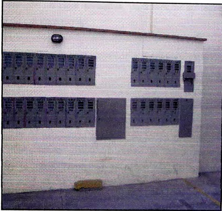
Foto N°2.4: Detalle de Banco de Medidores
