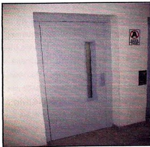
Foto N°2.8: Ascensor electromecánico con capacidad para 6 personas
