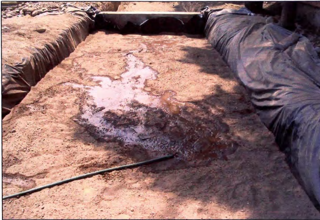
Foto 13 Saturación de la poza del tramo experimental
