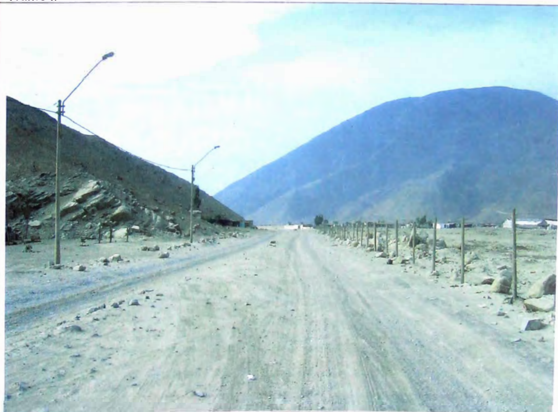
Foto N° 02 – En borde derecho cerco de alambrado granja carretera se encuentra por debajo de nivel original por erosión de tránsito vehicular en tramo Km. 6+400 – Km. 6+720.
