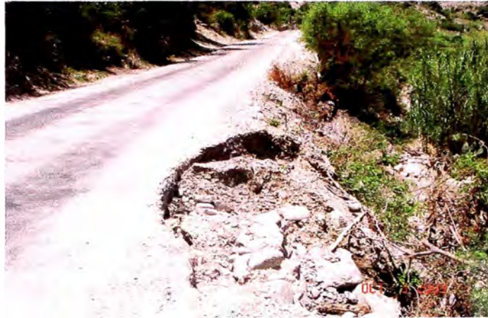
FOTOGRAFÍA 4.4 GRIETA DE BORDE
