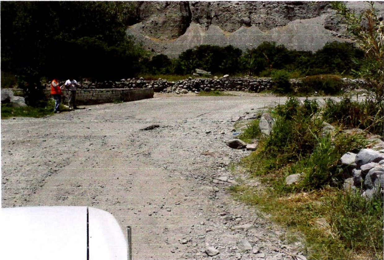
Foto 1 : Badén en tramo de carretera km 82+200 aprox.
