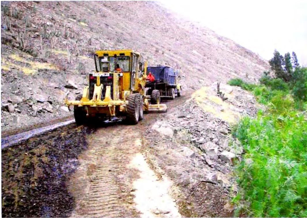
Foto. VISTA DE COLOCACION DE BASE ESTABILIZADA CON EMULSION ASFALTICA KM.99+000 AL KM.104+000.
