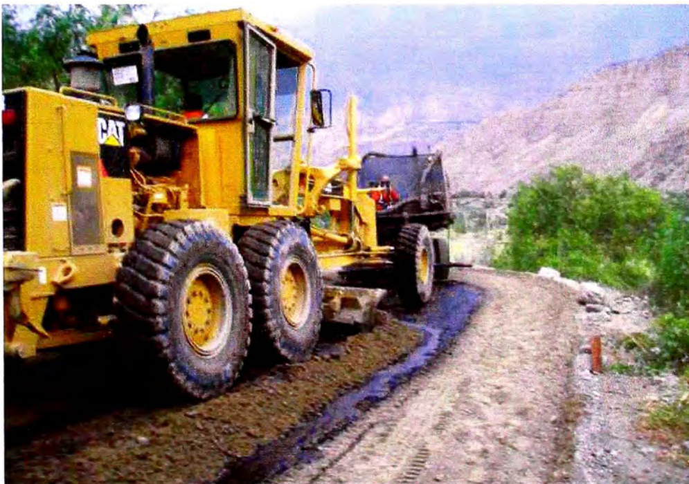
Foto. VISTA DE COLOCACION DE BASE ESTABILIZADA CON EMULSION ASFALTICA KM.99+000 AL KM.104+000.
